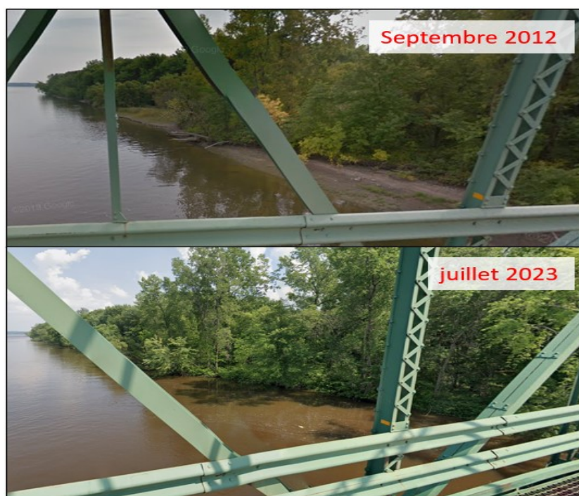
Figure 10-2 Évolution de l'érosion de la berge amont droite entre 2012 et 2023 (Google Maps)
