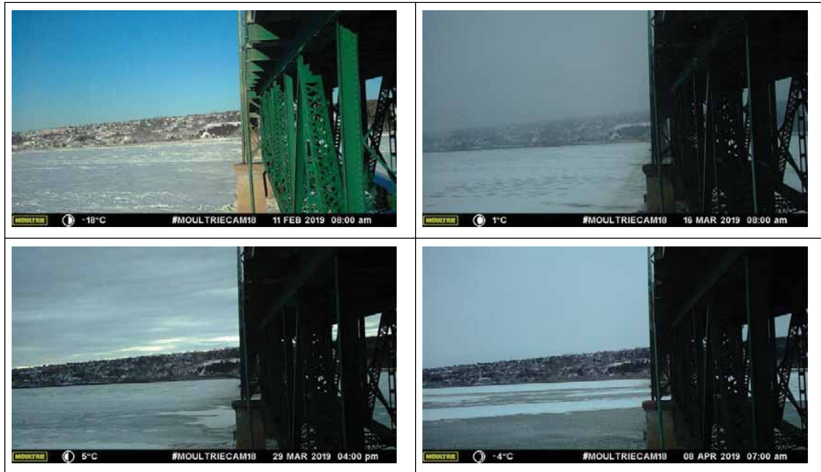
Figure B-1 Couvert de glace du côté amont, vers la rive nord, en 2018-2019
