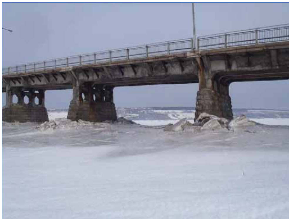
Figure 10-4 Couvert de glace à l'extrémité sud-ouest du pont le 21 mars 2019
