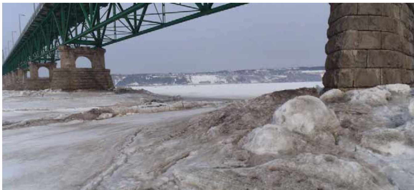
Figure 10-5 Couvert de glace à l'extrémité sud-ouest du pont le 21 mars 2019
