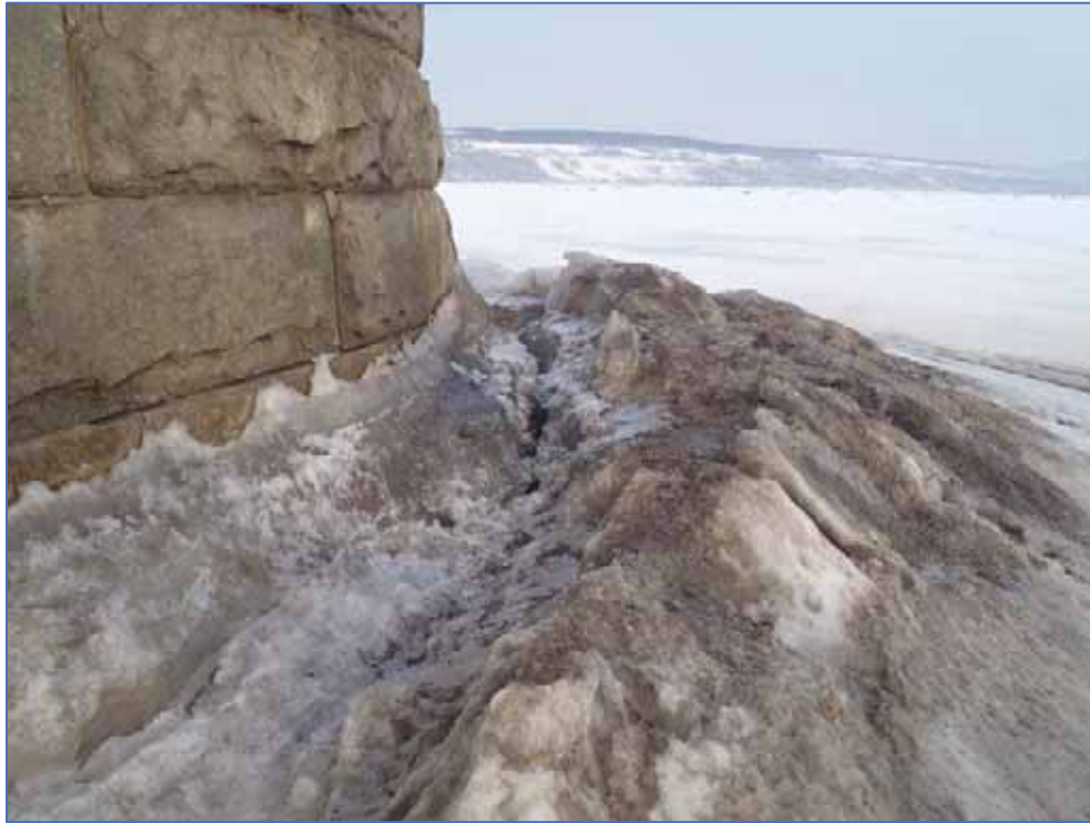
Figure 10-6 Couvert de glace à l'extrémité sud-ouest du pont le 21 mars 2019 – Interaction pile/glace
