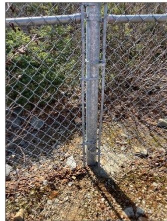
Photo 16 Site B – Bris de la clôture (après)
