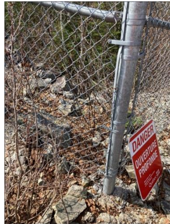
Photo 12 Site A – Ouverture dans la clôture et enseigne décrochée (avant)
