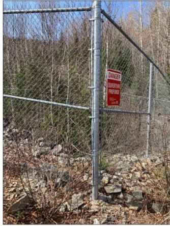
Photo 13 Site A – Ouverture dans la clôture et enseigne décrochée (après)
