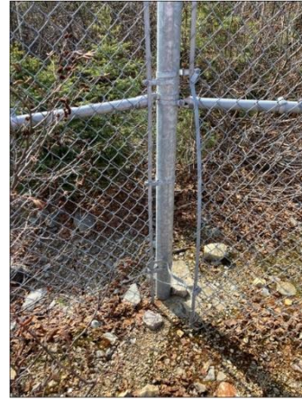
Photo 14 Site B – Bris de la clôture (avant)
