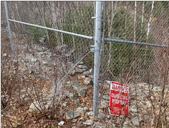
Photo 11 Site A – Ouverture dans la clôture et enseigne décrochée (avant)
