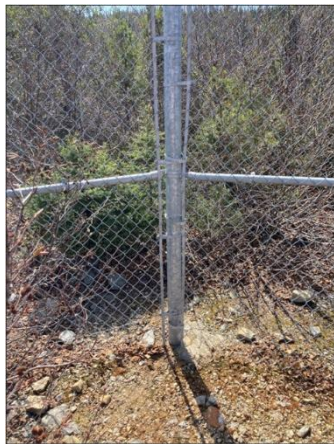
Photo 15 Site B – Bris de la clôture (après)
