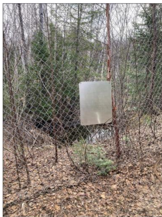
Photo 17 Site C – Enseigne décrochée (avant)
