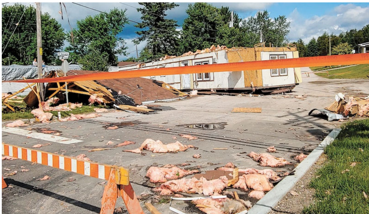
Figure 2.1 : Exemple de dommages causés par la tornade du 21 août 2019 à Mont-Laurier Source : Journal de Montréal
