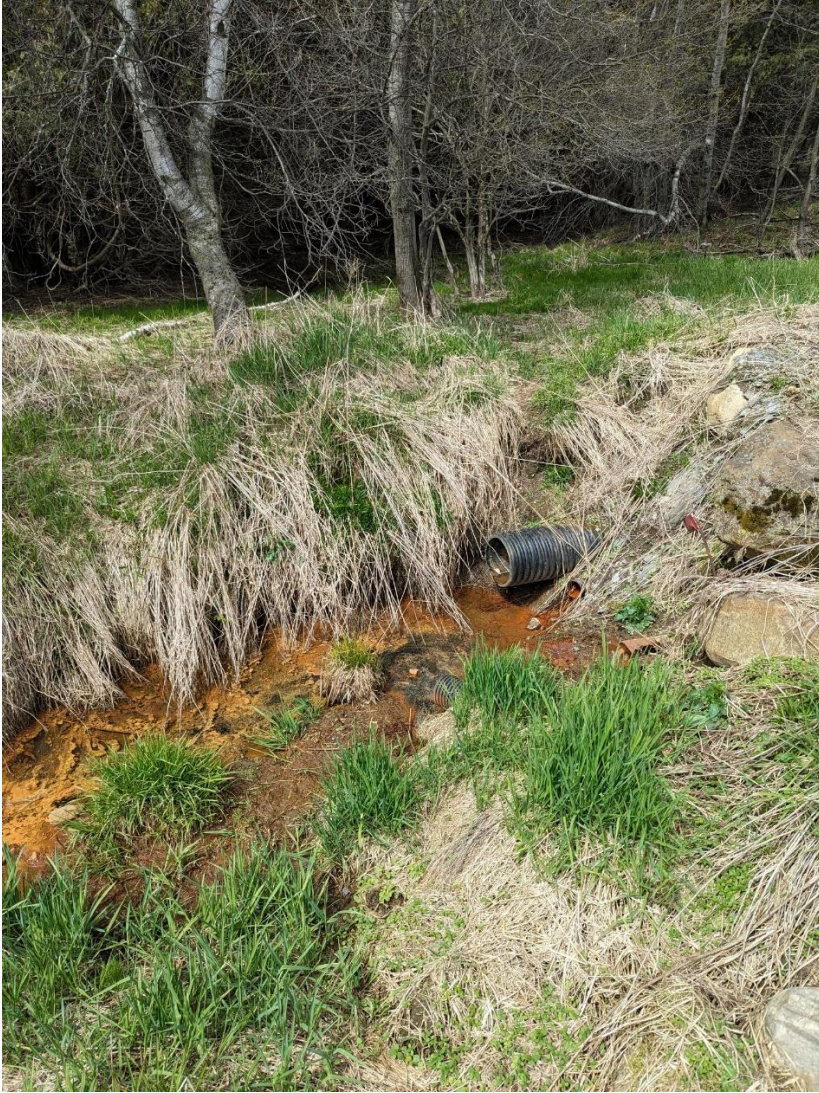
Figures 6 : Embouchure des drains
