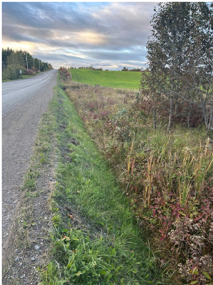
Absence d'un lit d'écoulement (fossé)
