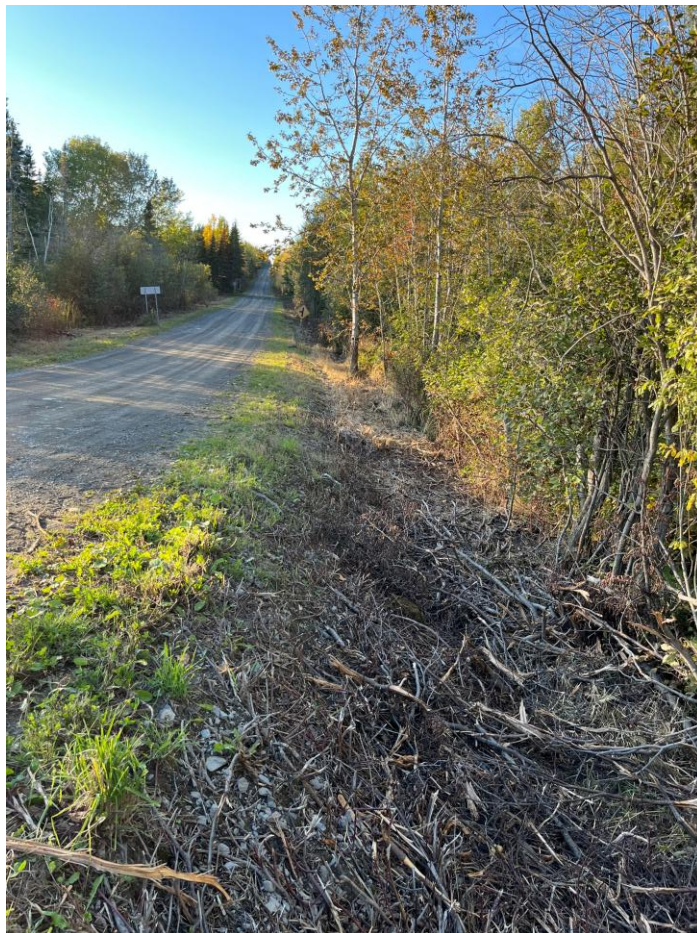
Absence d'un lit d'écoulement (fossé)
