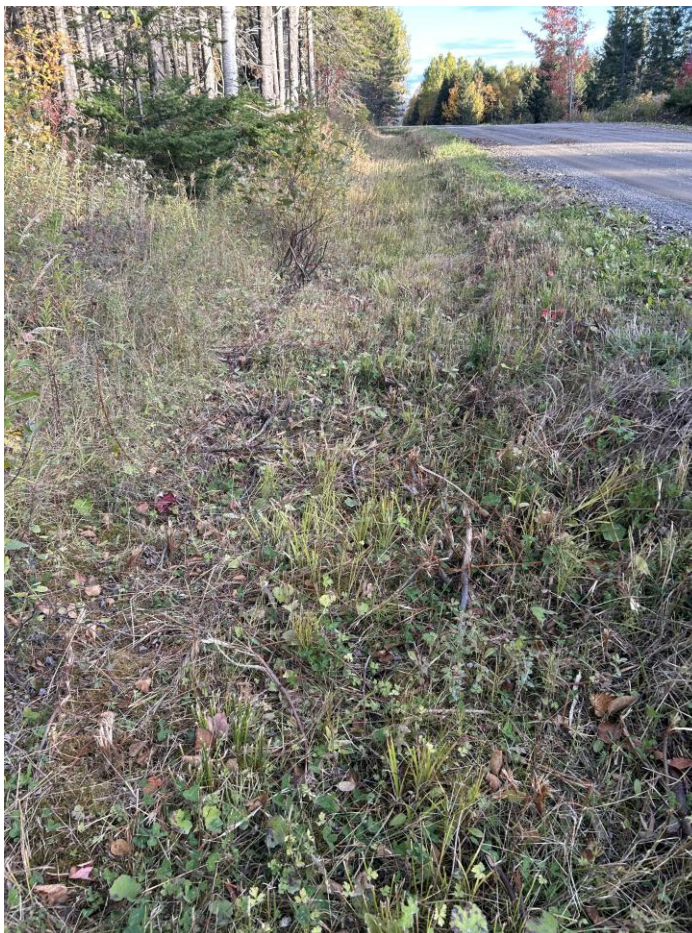
Absence d'un lit d'écoulement (fossé)
