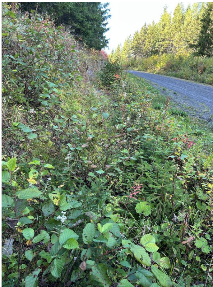
Absence d'un lit d'écoulement
