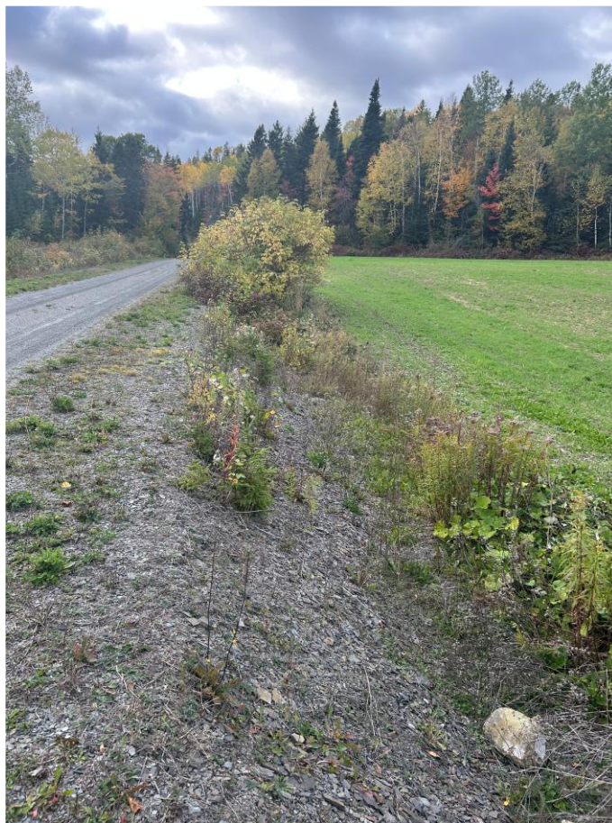
Absence d'un lit d'écoulement (fossé)
