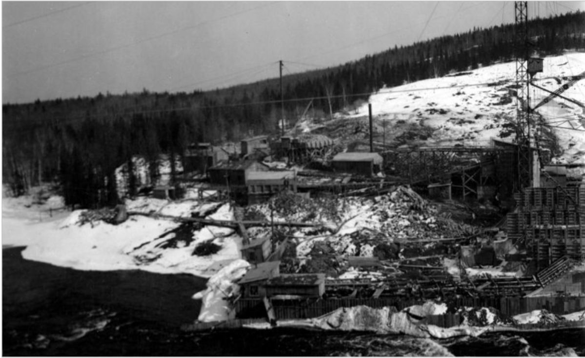
Photo 1. Vue générale de la rive droite du barrage Matawin en phase de construction (1930)
