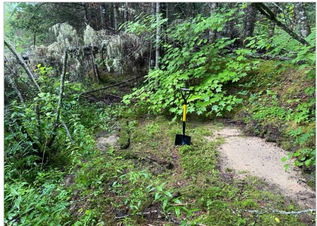
Photo 8. Faible érosion du talus en rive droite vers le PK 80,7
