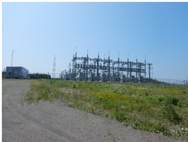
Photo 13. Poste de raccordement au centre sud du site à l'étude
