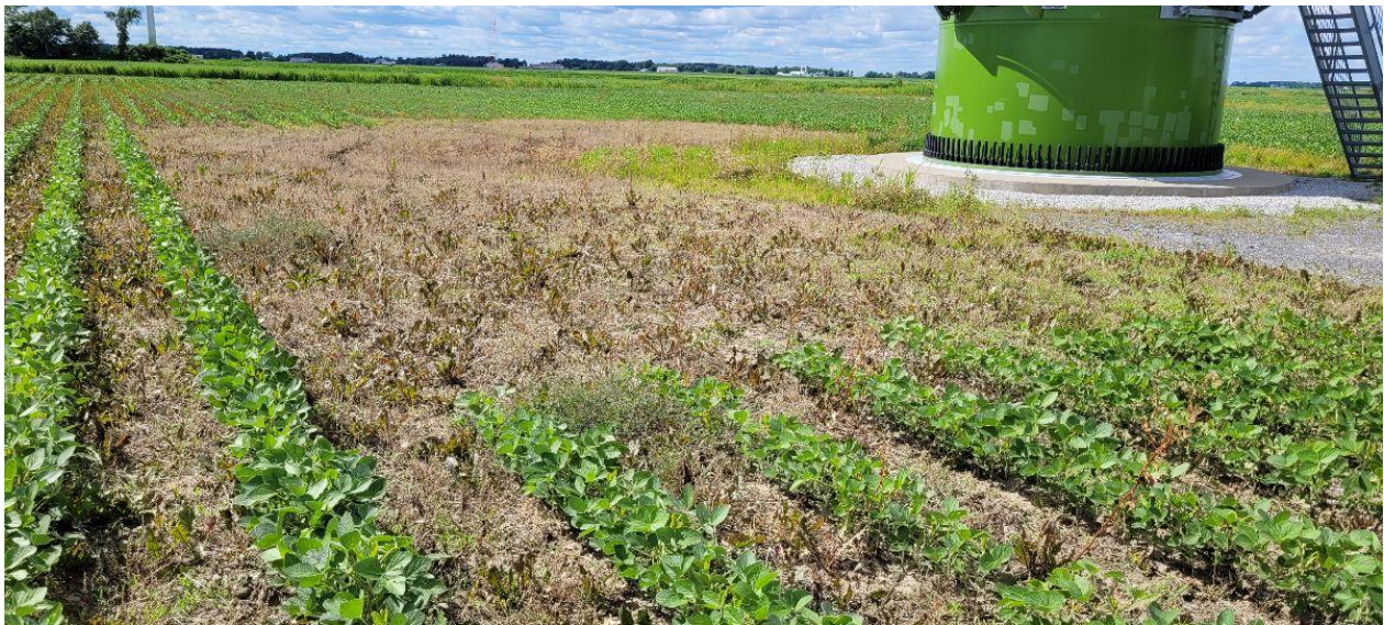
Figure 10. Éolienne T6 – Problématique de drainage à l'ouest de l'éolienne, avant les travaux de réparation de drain – Parcelle JMH-3 (07/2025)
