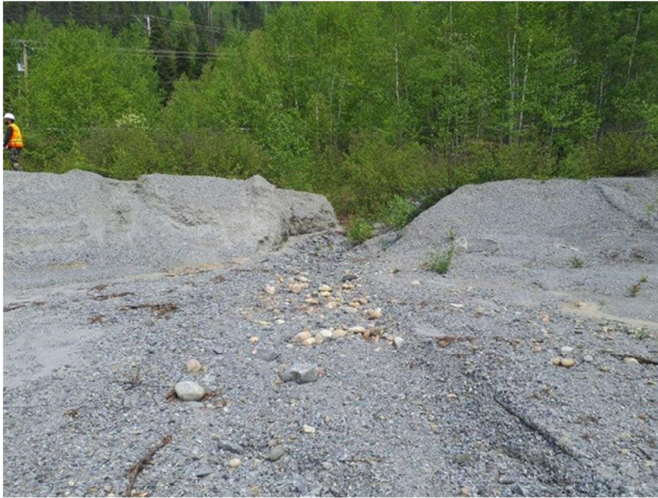
Photo 3 Signes d'érosion - secteur de la pile de pierre concassée 0-20 mm (SPC-01) – Vue vers l'est
