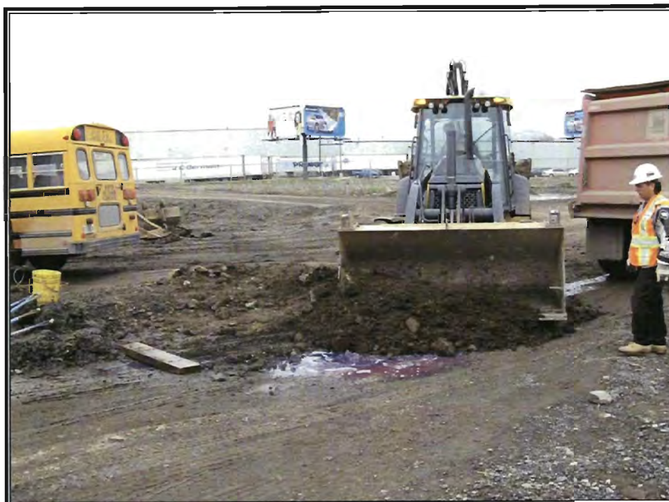
Photo 11 : Absorption du produit déversé au moyen de sols et excavation de ces sols.
