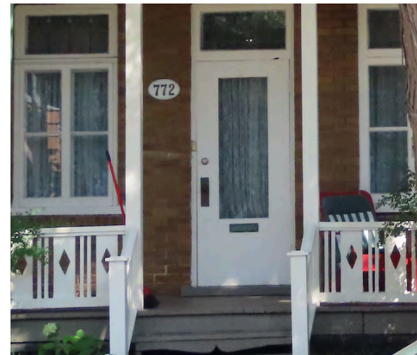
Détail du garde-corps intégrant barreaux et éléments découpés à jour au 770-772, chemin de la Canardière.
