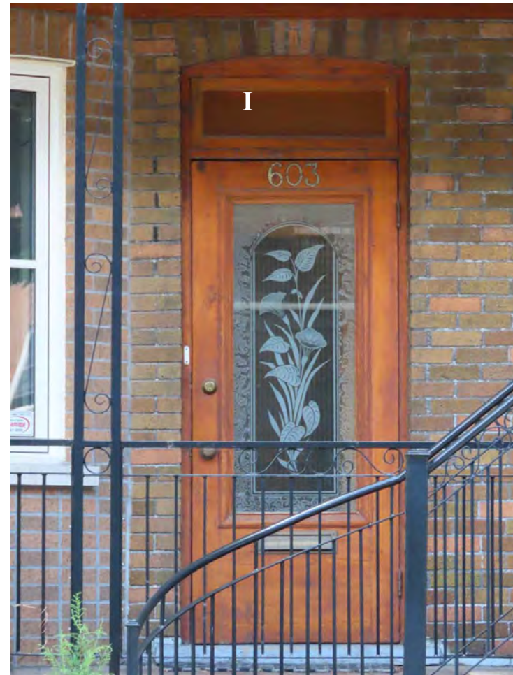
Porte d'origine en bois, à simple vantail, avec imposte (I), au 603-607, 4 e Avenue.
