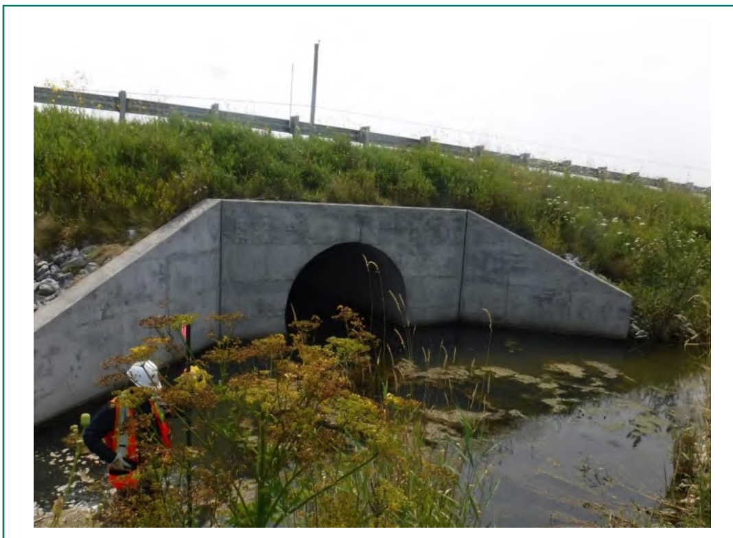
Photo 27 : Aperçu du ponceau permettant au ruisseau Bellefroid-Dandurand de traverser la route 202 et de la fosse présente à son entrée
