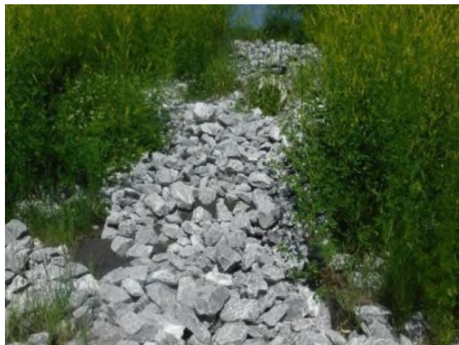
Enrochement non encastré en amont du ponceau P05 du ruisseau Bellefroid-Dandurand (MTMD, 2022)
