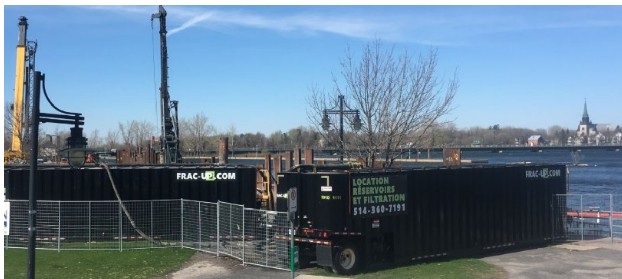
Photo 4.6.2 : Système de conteneurs filtrants de type Frac-Up
