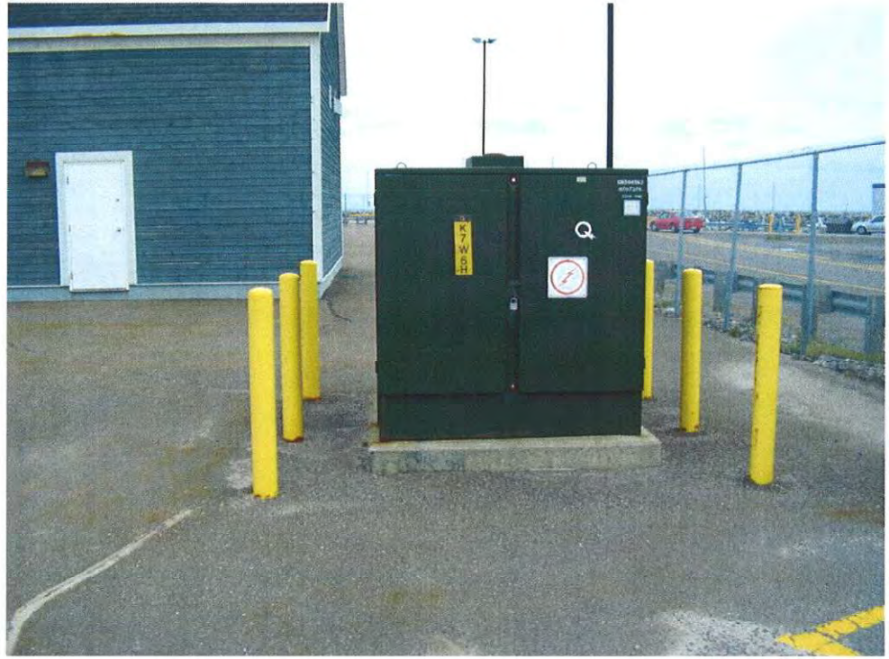
Photo n° 35. Transformateurs appartenant à Hydro-Québec retrouvés sur le site, près du garage.
