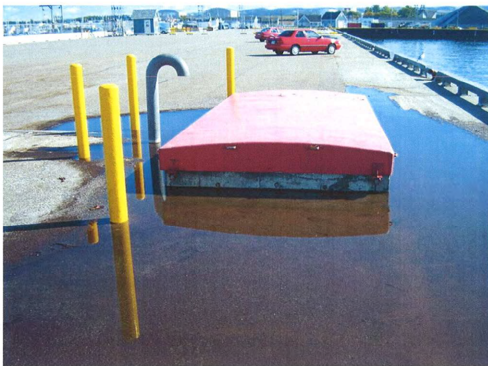
Photo n° 30. Boîte de vanne de Pétro Canada
