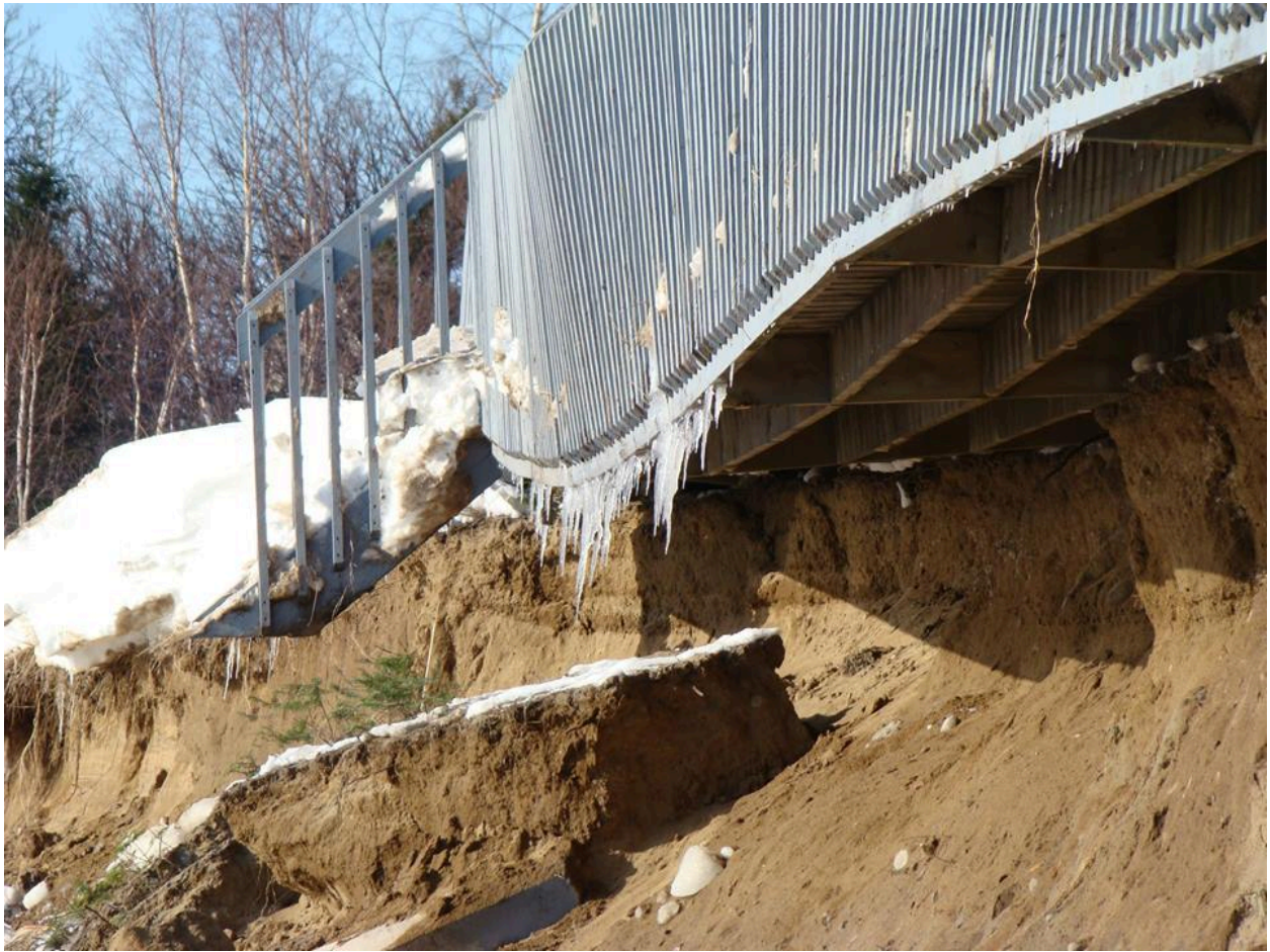
Figure 5: L'érosion sous la promenade de la plage Rochelois, 24 février 2017
