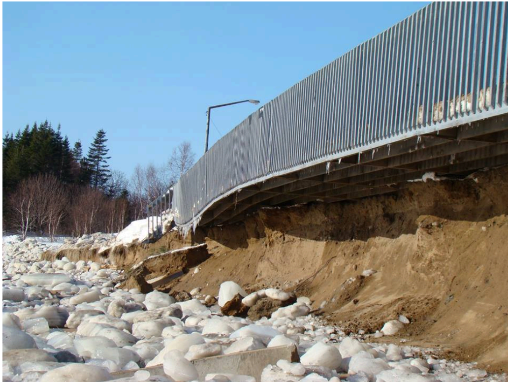
Figure 4 :L'érosion sous la promenade de la plage Rochelois, 24 février 2017
