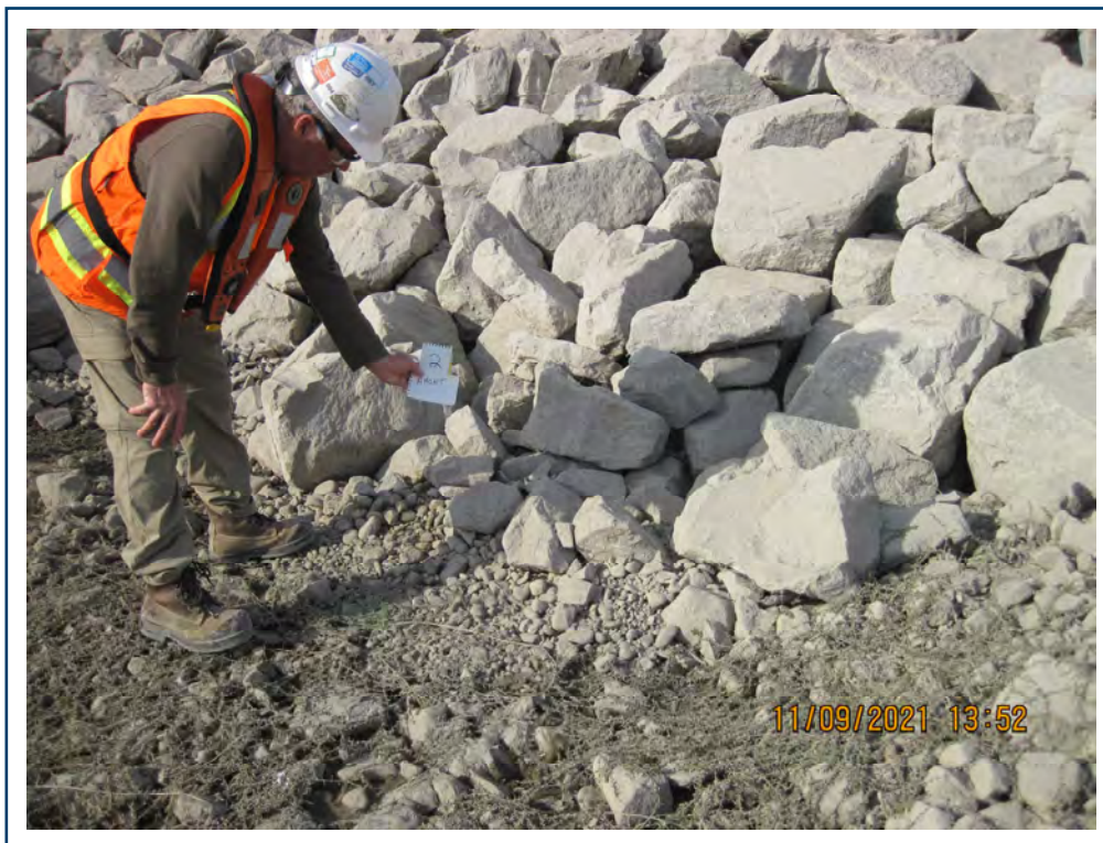
PHOTO 2 — Secteur amont, nid 2 (détruit par le perré du filtre inverse)
