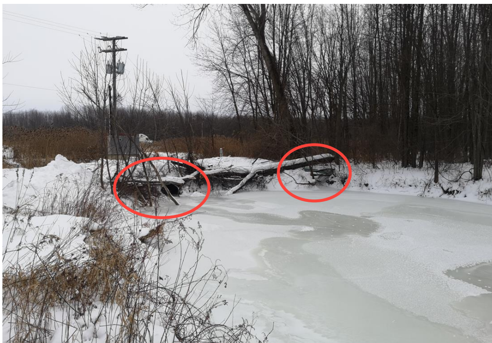
Photo 1 Vue sur la buse d'entrée de la station de pompage (à gauche) et sur l'entrée du fossé préexistant (à droite) depuis le bassin de rétention amont
