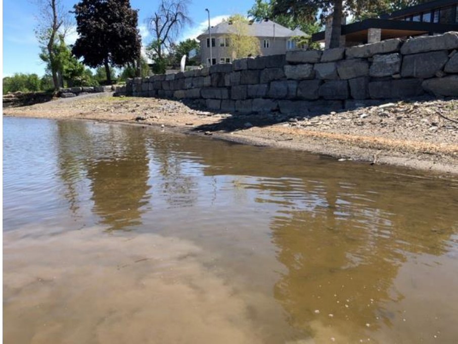
Figure 2.6 : Mur de soutènement, rive sud, à l'aval du ponceau P 09774 (source : Consortium Avenir A15)
