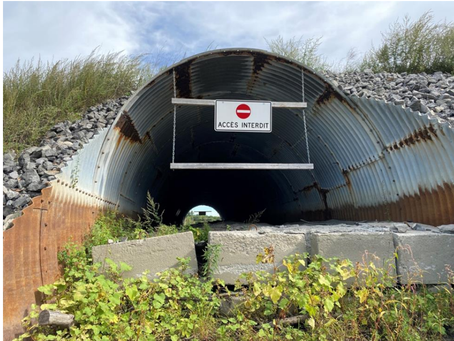
Figure 6.11 : Radier comblé et présence de blocs de béton à l'entrée du ponceau, sous la jetée de l'approche sud
