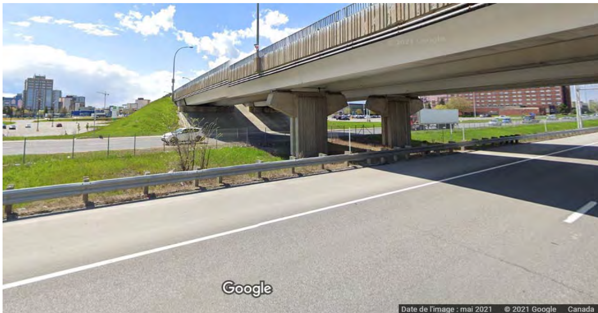
Photos 15 et 16 – Vues du pont du boulevard le Carrefour de chaque côté de l'A15 construit sur du remblai (Source : Google Street View)
