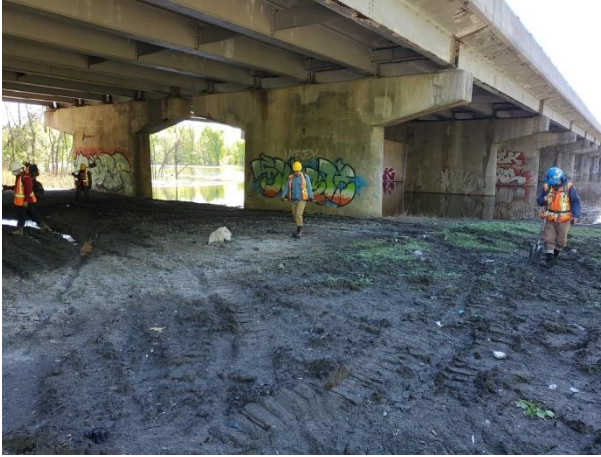
Figure 21: Zone A3, zone boueuse, plane et sans végétation avec assise de pont, vers l'est
