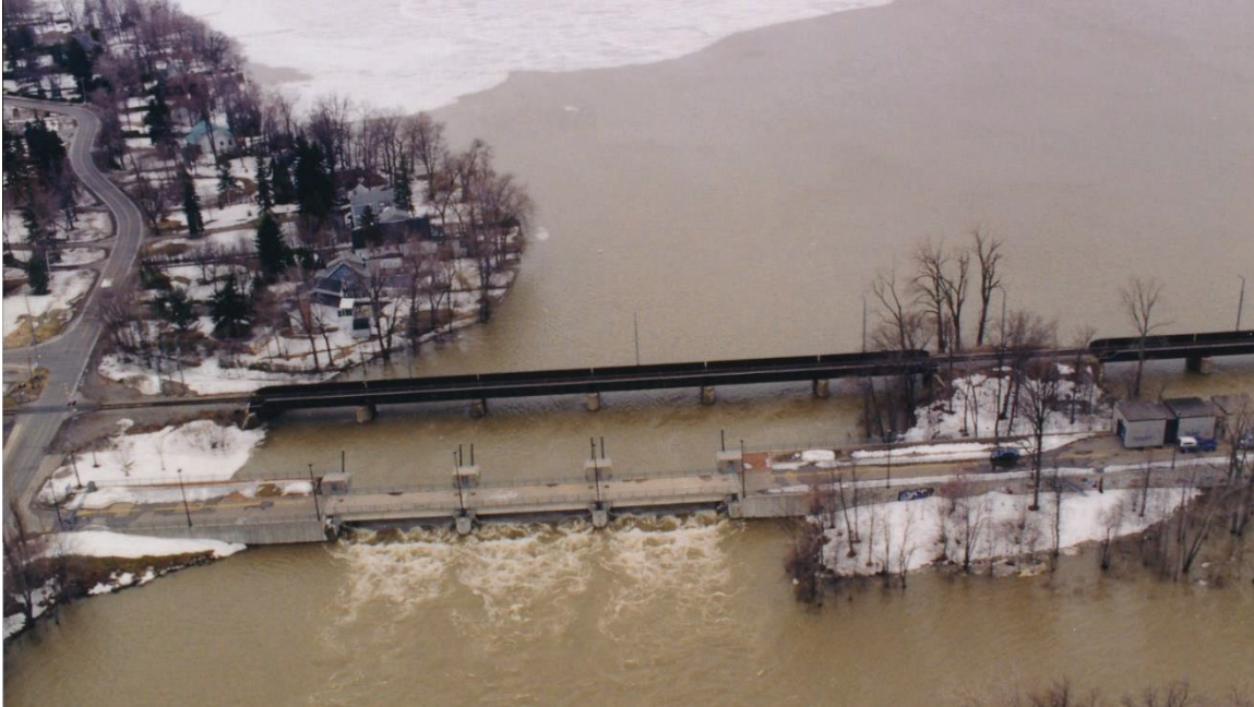
Figure 7.9 Conditions d'écoulement au barrage du Grand-Moulin en avril 1998 : Débit ~800 m 3 /s (source : Archives de la Ville de Laval)
