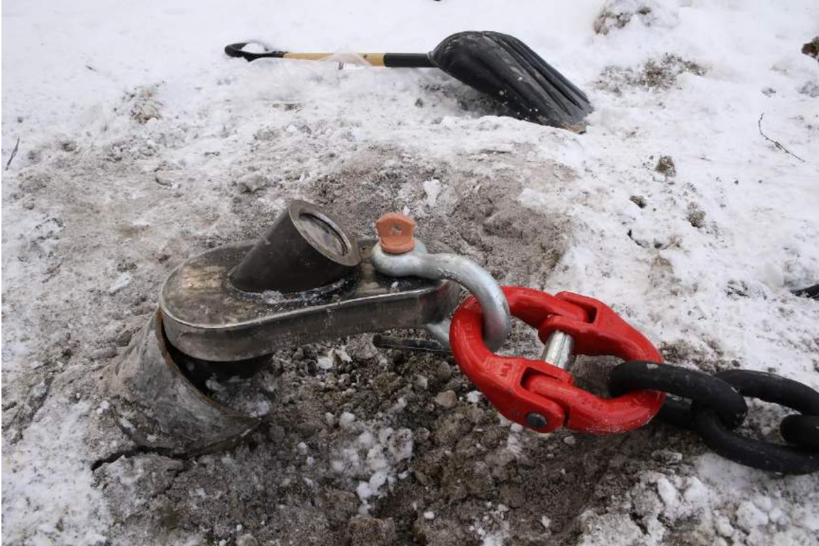
Photo 1. Tête d'un ancrage de l'estacade (noir) avec maillon faible (gris) et manille (rouge) pour attacher la chaîne (noir foncé). (La présence de la pelle est là à des fins d'échelle.)
