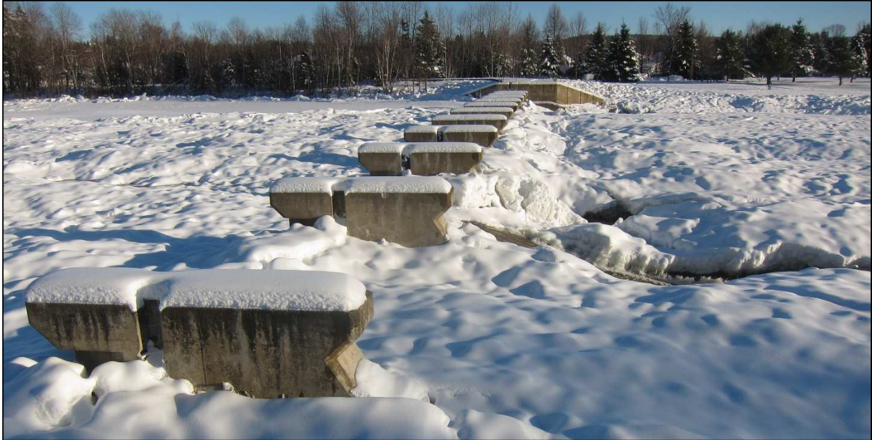
Figure 1. Barrage Estacade submergé par les glaces le 19 décembre 2014 (vue de la rive droite, le courant allant de gauche à droite). Cette situation est causée par l’impossibilité de former un couvert de glace hâtif à l’amont du barrage Estacade dans le réservoir de ce dernier, ce qui expose la ville à des inondations fréquentes.
