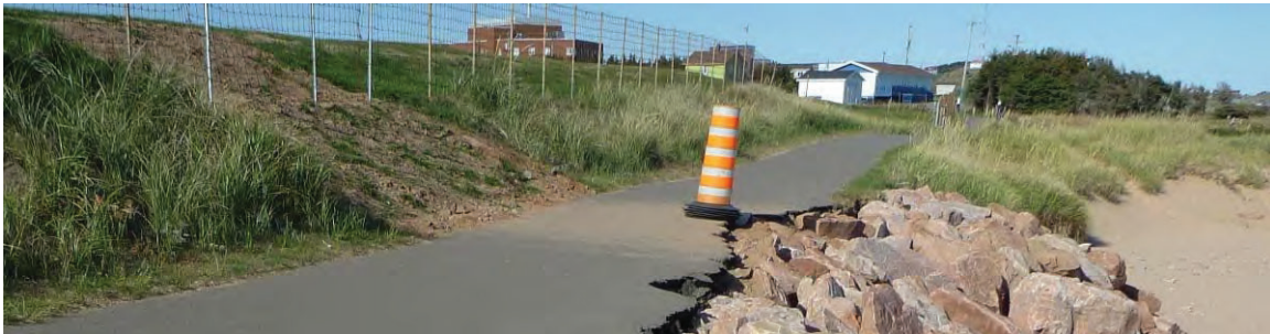
Figure 9.10 Dommage infligé par le franchissement des vagues sur le talus des étangs aérés
