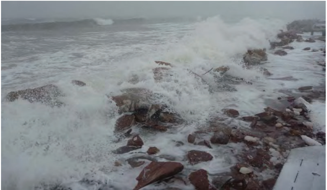
Figure 2.17 Secteur du chemin des Chalets– Tempête du 27 janvier 2011 – Franchissement par les vagues des protections en enrochement
