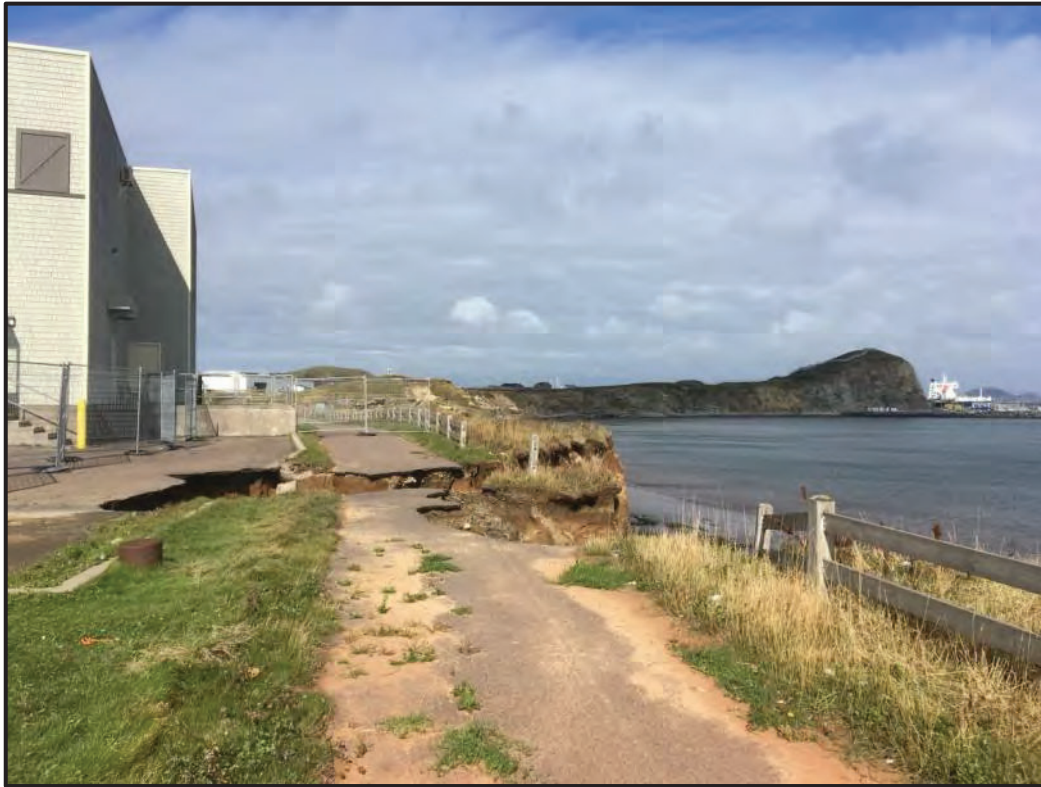
Photo 1. Vue vers le nord montrant l'ampleur des effondrements et de l'érosion du remblai qui touchent la piste cyclable et le stationnement.
