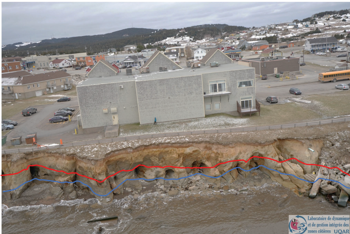
Figure 4. Vue oblique de la falaise devant le bâtiment du 380 chemin Principal (cinéma) avec niveau d'eau de récurrence 50 ans (ligne bleue) et remontée de vagues (ligne rouge)
