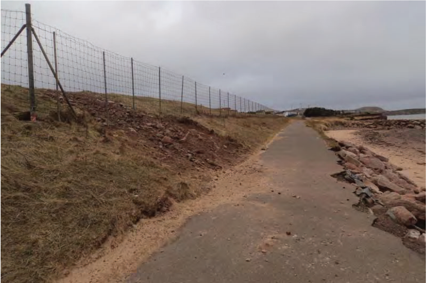
Figure 2.7 Érosion de la promenade le long des étangs aérés et effet du franchissement des vagues
