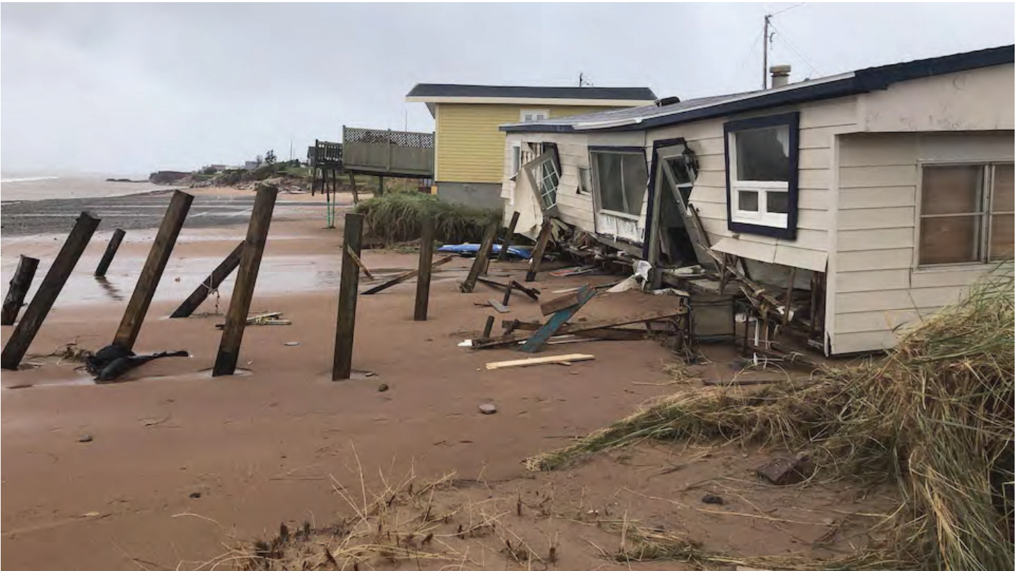
Une résidence a été endommagée par le passage de Dorian aux Îles-de-la-Madeleine.
