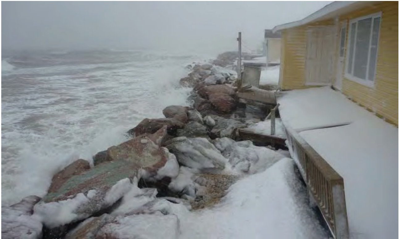
Figure 2.19 Chalets du secteur du chemin des Chalets– Tempête du 27 janvier 2011 – Les dommages constatés sur la galerie du chalet datent de tempêtes précédentes
