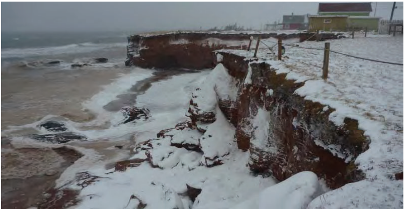
Figure 2.26 Pointe de la Martinique – Érosion de la falaise
