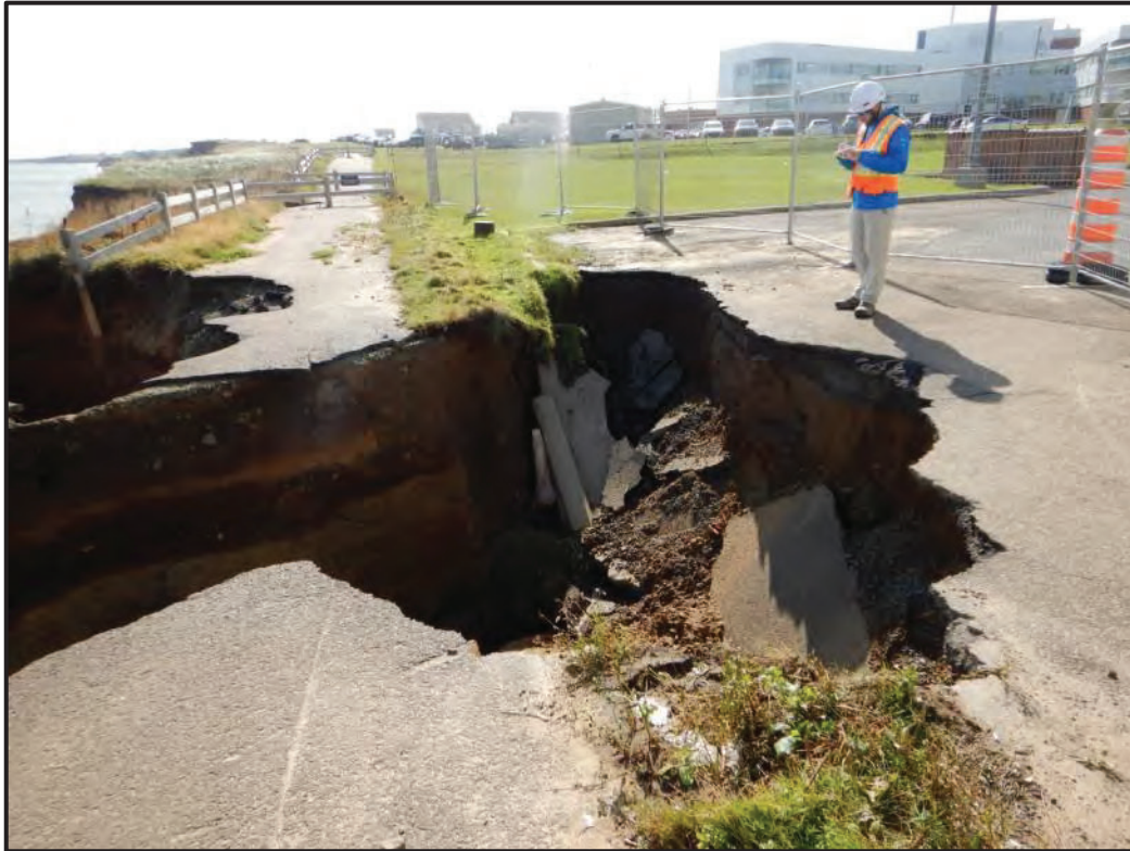
Photo 2. Vue vers le sud du remblai et des sols meubles érodés jusqu'au roc au droit de la piste cyclable et du stationnement.
