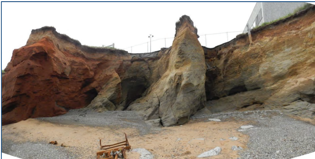
Photo 2. Vue des deux effondrements de la photo 1 prise à partir de la plage. La profondeur de la grotte sous l'effondrement de droite sur la photo atteint 3,5 m.
