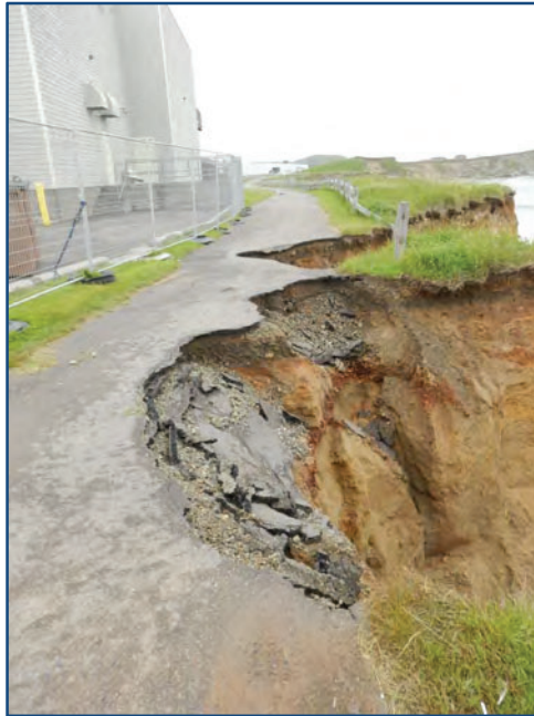
Photo 1. Effondrements qui ont touché la piste cyclable.
