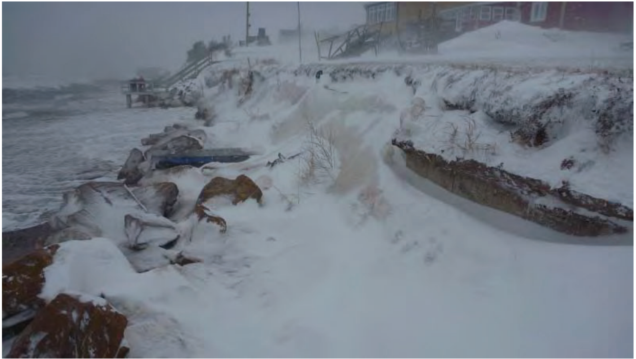
Figure 2.29 Pointe de la Martinique – Protection en enrochement inefficace (franchissement par les vagues et érosion du talus derrière l'enrochement)
