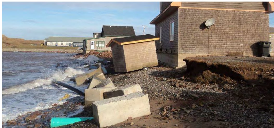
Photo prise en 2015 après une tempête
