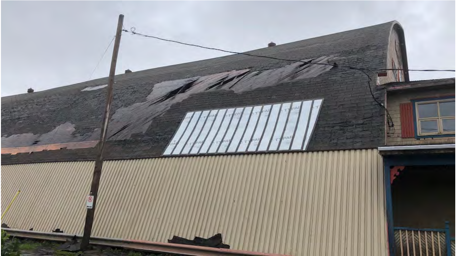
La toiture de l'ancien aréna de Cap-aux-Meules a été endommagée.
