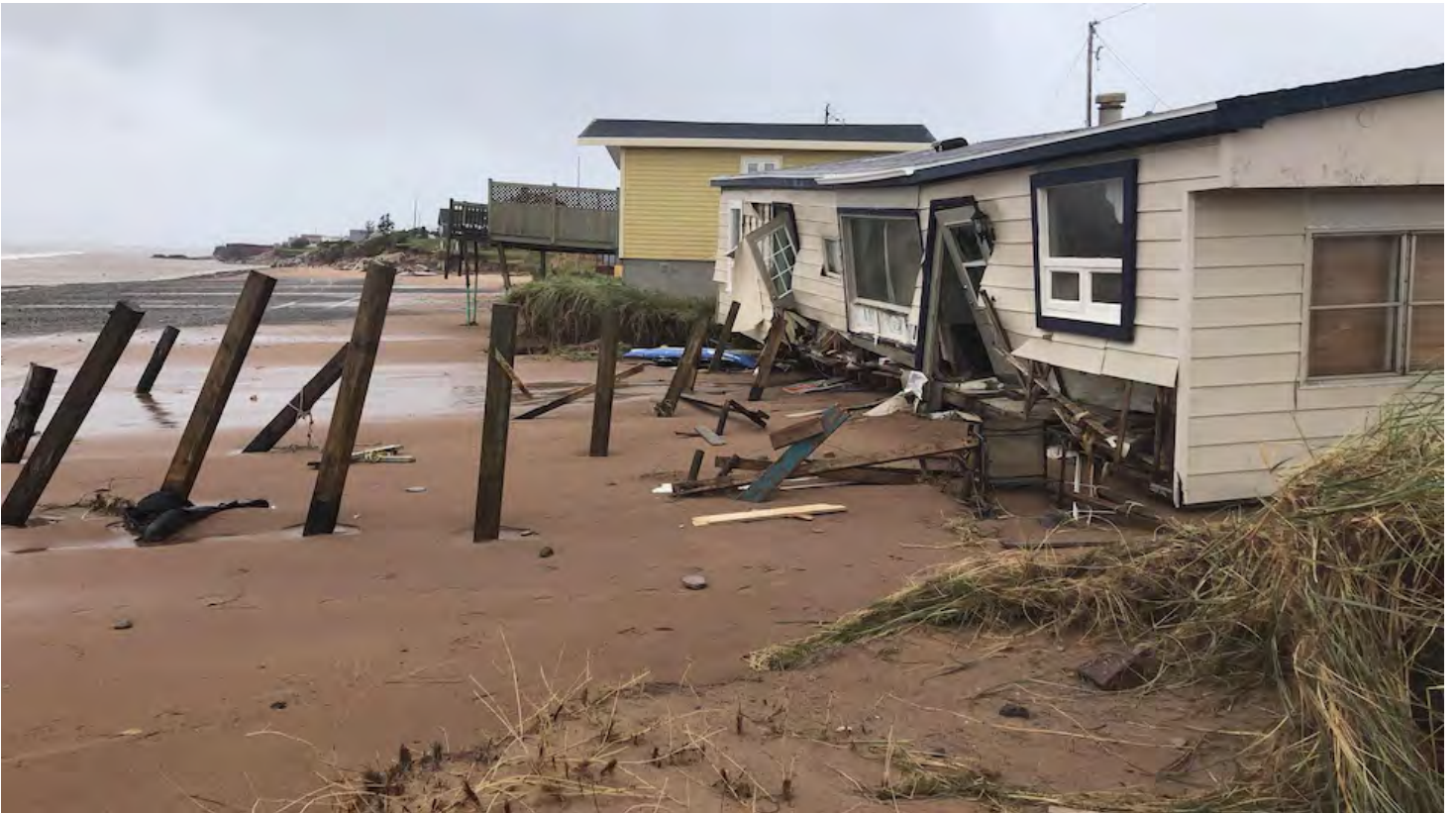
Une résidence a été endommagée par le passage de Dorian aux Îles-de-la-Madeleine.
