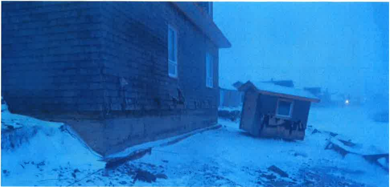
Figure 2.37 Fondation de maison exposée par l'érosion de la plage
