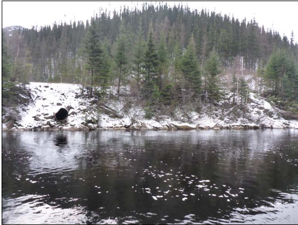
Photo 19. Ponceau n° 1, infranchissable au moment de la visite, rivière Nipissis, PM 52, 16 novembre 2017
