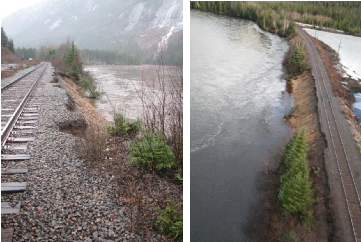
Figure 6.1 Glissement de terrain entre les points milliaires 52.69 et 52.86 en décembre 2010 (Journeaux et Assoc., 2011)
