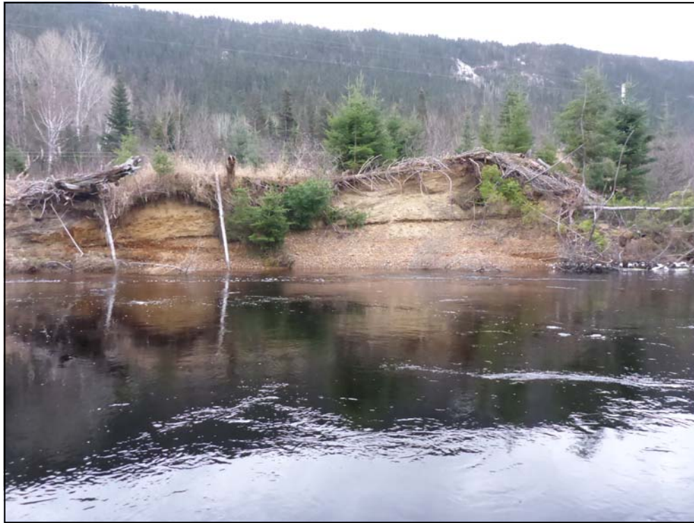
Photo 3. Foyer d'érosion n° 1 en aval de la zone des travaux, rive gauche de la rivière Nipissis, PM 36, 9 novembre 2017
