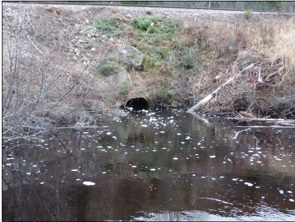
Photo 7. Ponceau simple (franchissable sous réserve) situé dans la partie aval de la zone des travaux, rivière Nipississ, PM 36, 9 novembre 2017
