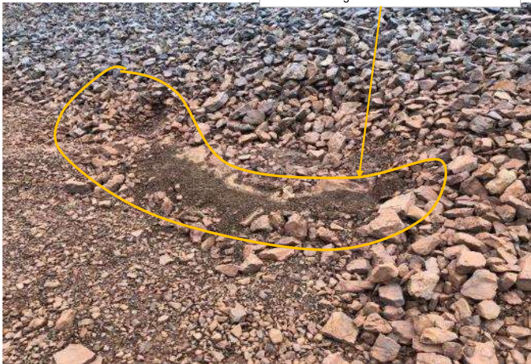
Photos 5 et 6 : Déchirure dans la membrane du talus interne de la digue sud et dépression en haut du talus dans le même secteur
