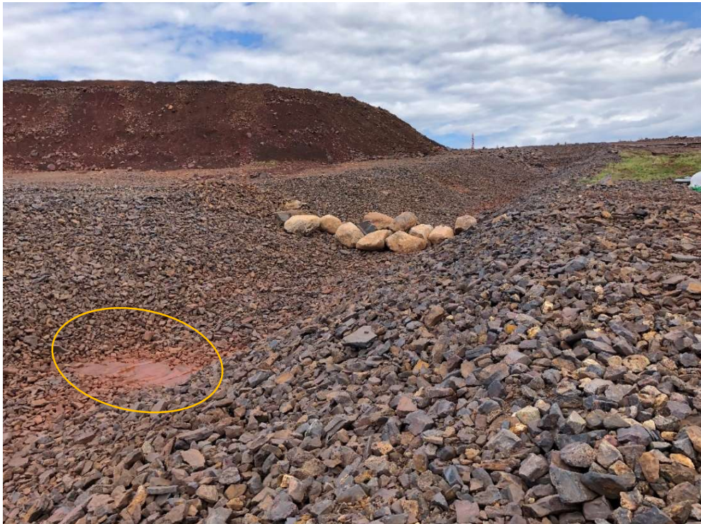
Photo 17 : Fossé en amont du bassin de sédimentation, exemple d'une des trois zones où le géotextile est découvert
