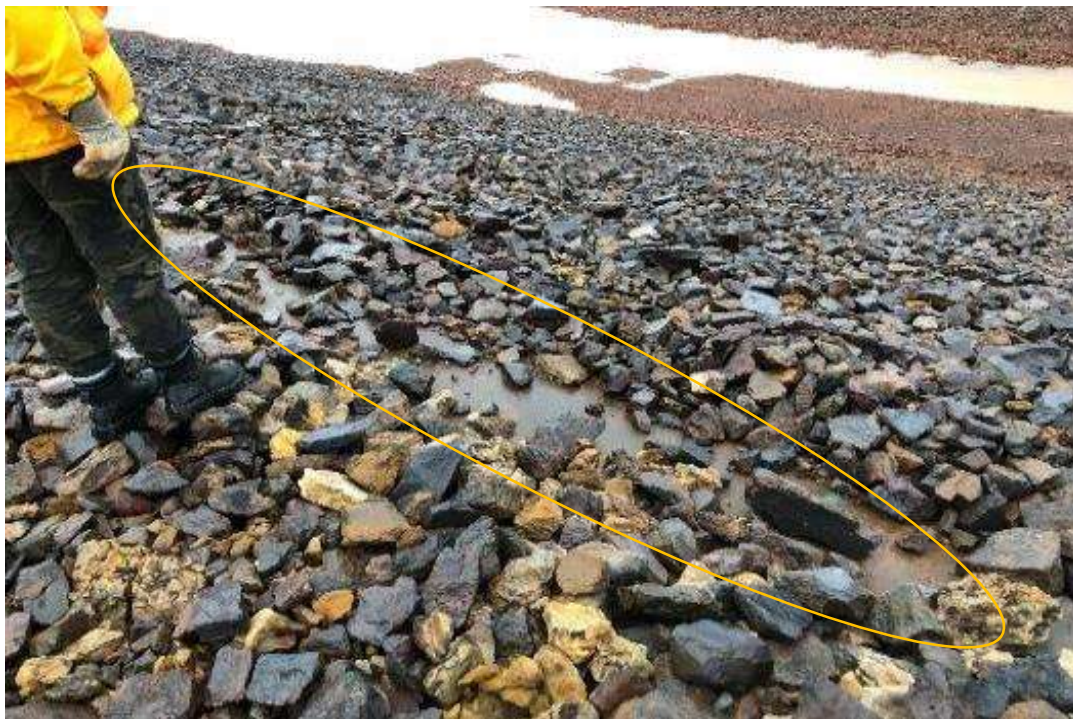
Photo 2 : Digue Sud, exemple d'une portion découverte de la membrane dans le talus interne
