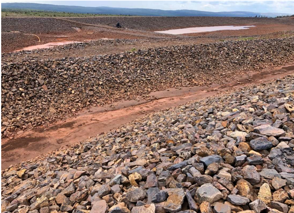
Photo 18 : Fossé entre la halde à stériles et le bassin de sédimentation, géotextile découvert à plusieurs endroits et sédiments dans le fossé.
