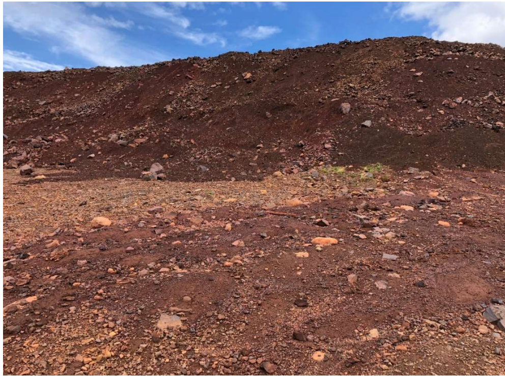
Photo 11 : Halde à stérile, Talus Sud, dans la portion est, plusieurs décrochements de surface sont visibles
