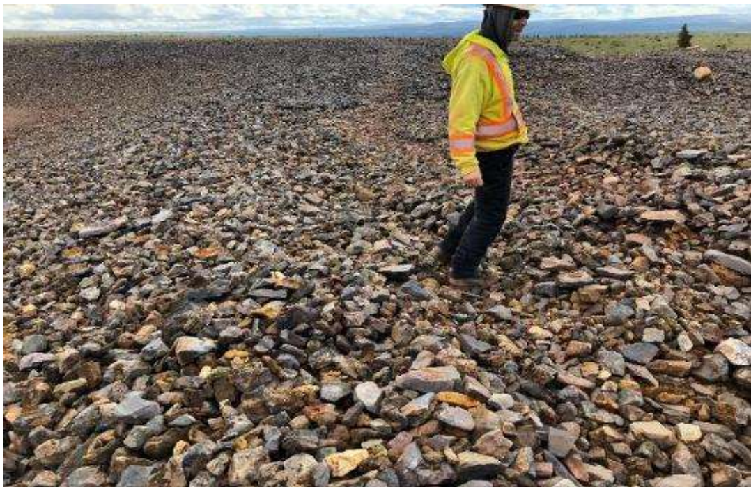
Photo 4 : Digue Sud, une nouvelle dépression est observée sur la partie interne de la crête
