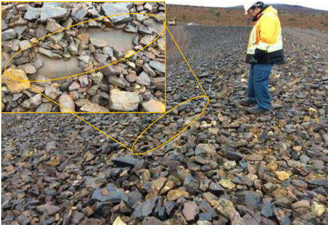
Photo 3 : Digue Sud, exemple d'une portion découverte de la membrane dans le talus interne
