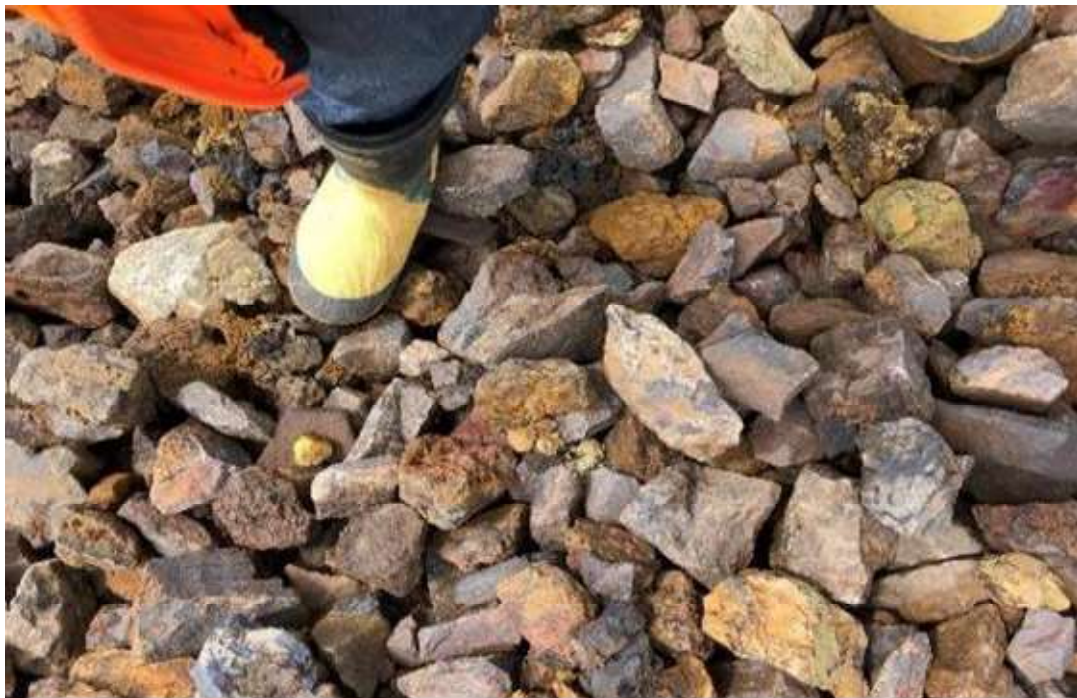
Photo 8 : Bassin de sédimentation, la qualité de l'empierrement à l'intérieur du bassin est variable; après quatre saisons, plusieurs roches présentent un état avancé de dégradation
