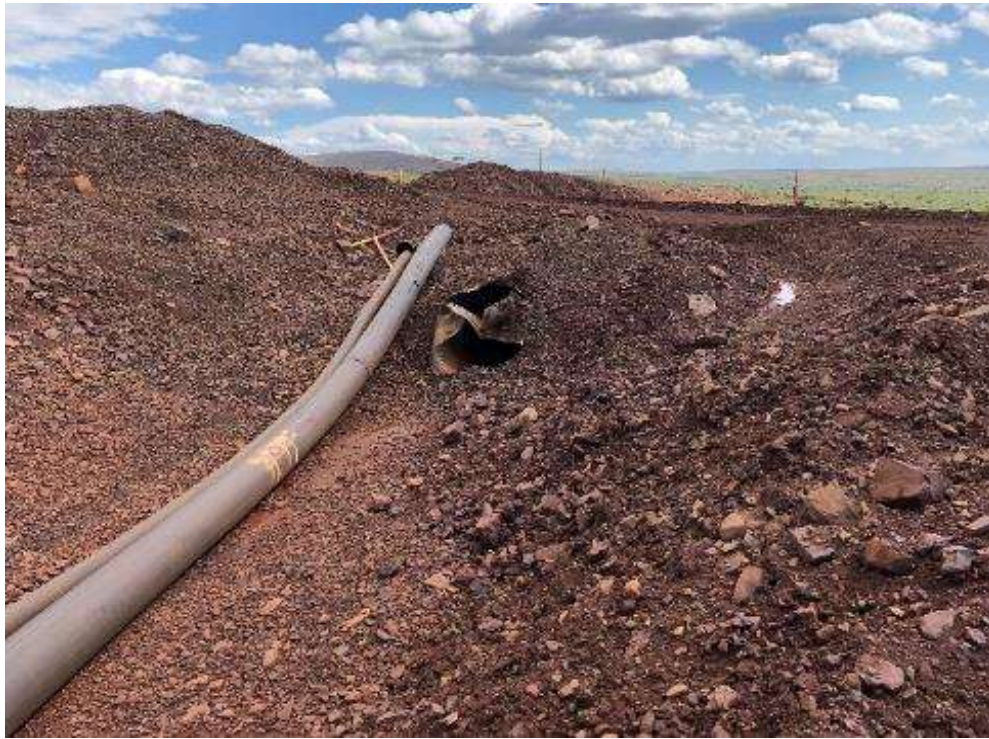
Photo 21 : Le ponceau à l'entrée de la halde, côté ouest, est brisé
