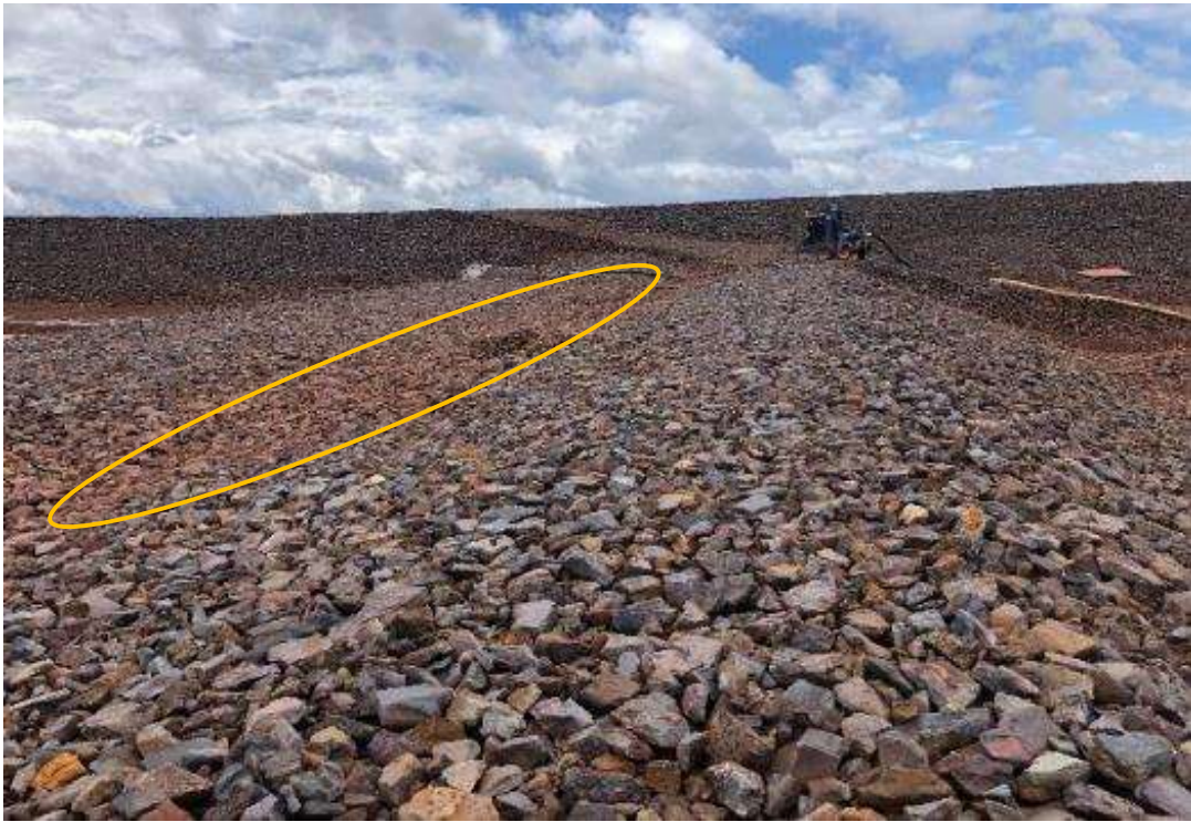
Photo 7 : Dépression dans le centre de la digue médiane
