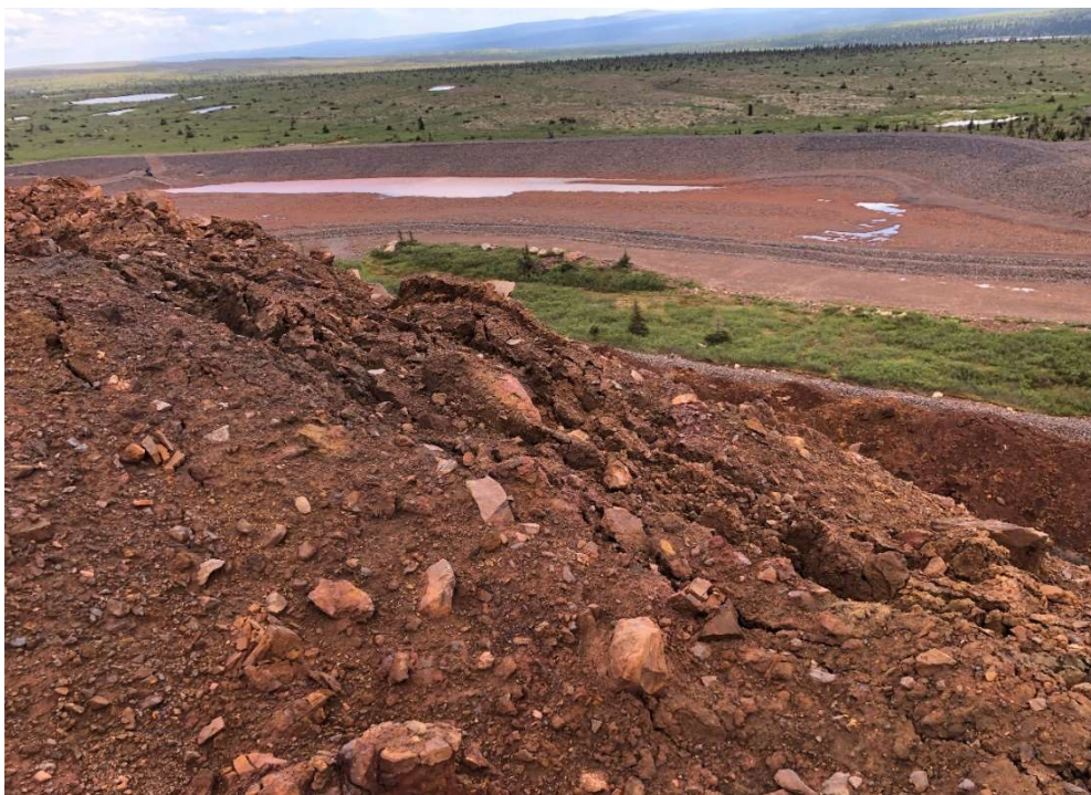
Photo 16 : Halde à stériles, exemple de fissures en crête de talus
