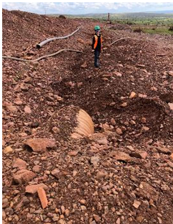
Photo 20 : Le fossé est bouché, à l'est du ponceau à l'entrée de la halde
