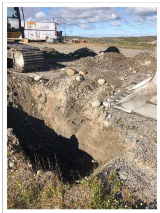
PHOTO 4 — Vue de la réalisation du puits d'exploration PU-20-03 situé dans le secteur des sols naturels remaniés (vue vers le nord, 31 août 2020)
