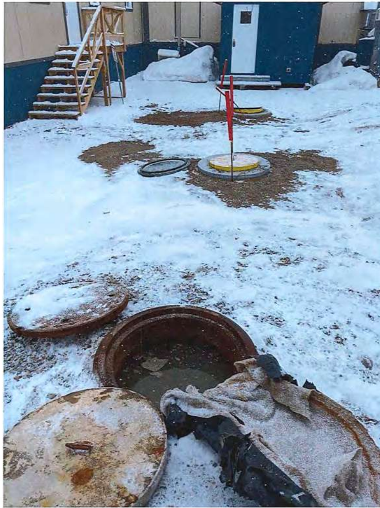
Photo 2: État des lieux tout de suite après le constat de déversement
