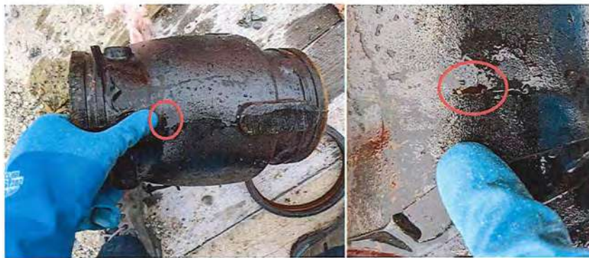
Photos 4 et 5 : Trou de rouille sur valve anti-retour
