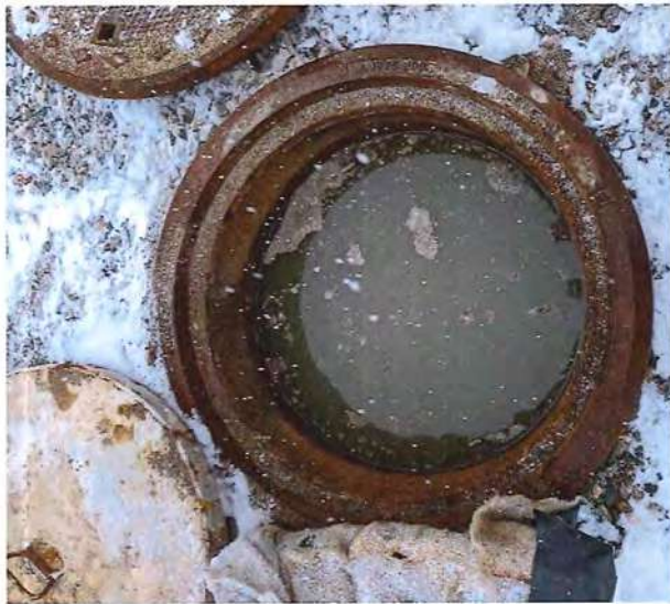
Photo 3: Trou d'homme (en ligne avec les trappes à graisse) plein d'eau car bouché en aval
