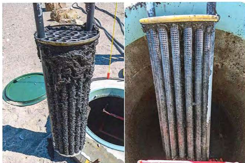
Photo 5: Préfiltre avant et après nettoyage
