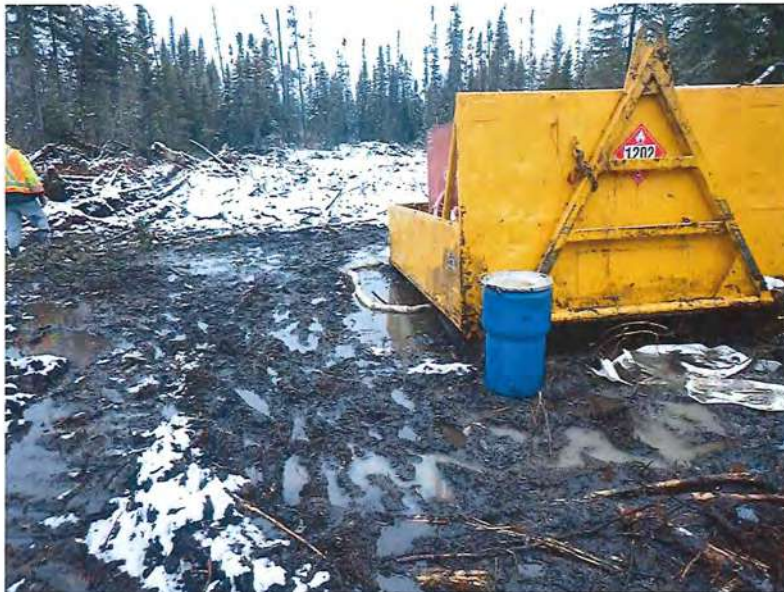
Photo 6: absorbants placés à la fin du nettoyage pour s'assurer qu'il n'y a plus d'huile sous le réservoir de diesel
