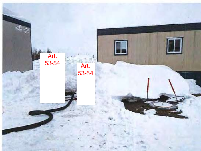
Photo 4: pompage de l'eau dans le 3ème trou d'homme le 17mars au matin pour décolmater le tuyau d'écoulement gravitaire vers la pré-fosse primaire
