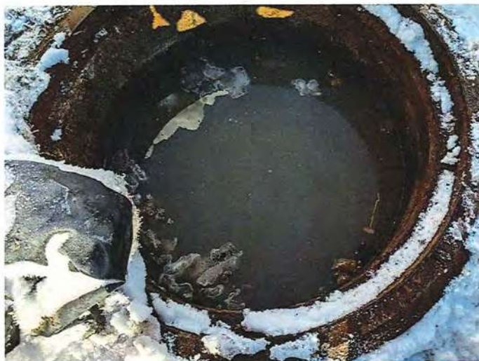
Photo 3: Trou d'homme (en ligne avec les trappes à graisse) bouché et plein d'eau
