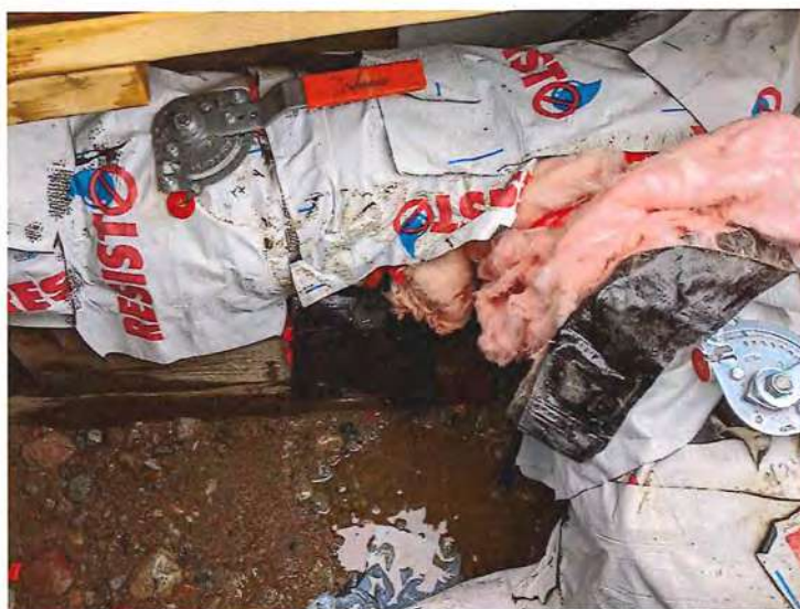
Photo 2 : flaque d'eau apparente suite à l'arrêt de la pompe
