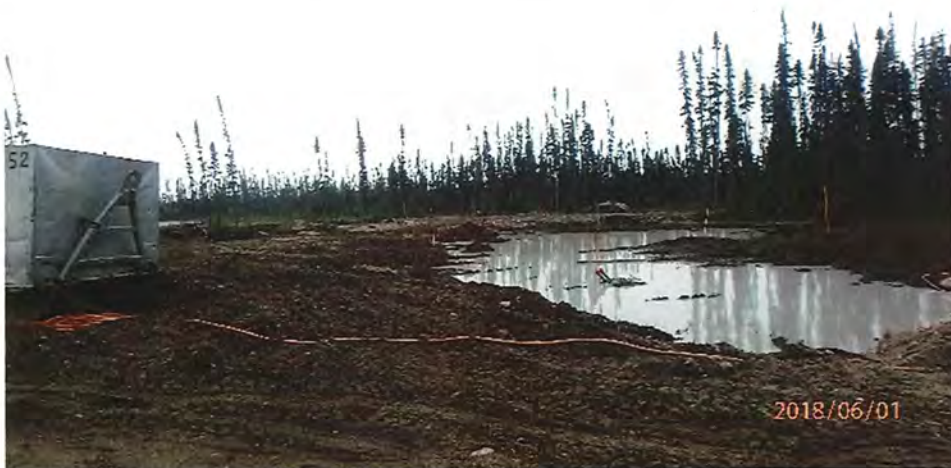
Photo 1 : Plateau inondé de boue de forage situé entre la foreuse 52 et le point d'entrée dans le ruisseau sans nom
