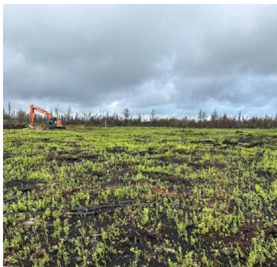
Figure 4-6 : Vue générale du site à l'étude (zone prévue pour la réalisation de l'étude)
