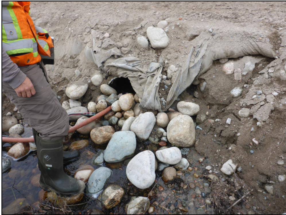
Photo 37 Ponceau constituant un obstacle infranchissable à la migration du poisson, segment S02, cours d'eau CE15 (2017)
