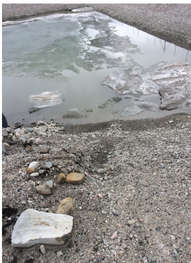
Figure 8 - Érosion pente amont côté Sud
