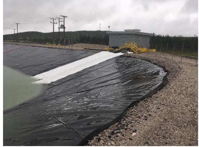
Photo 26 : Bassin de collecte d'eau et station de pompage.
