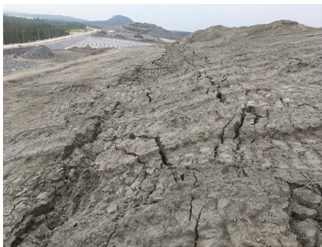
Photo 6 : Phase 1 du PAR. Pente aval des résidus avec des fissures longitudinales. Vue vers l'ouest.
