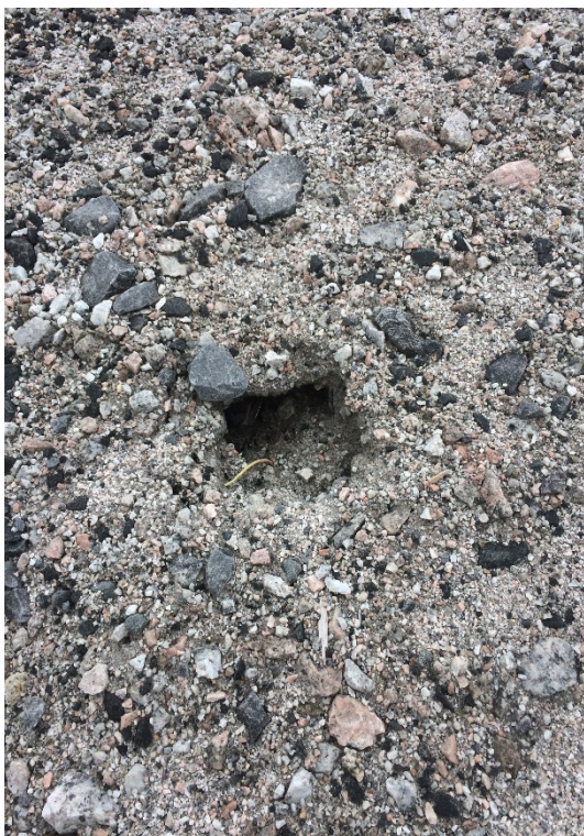
Figure 1 - Trous sur la crête côté Nord-Ouest
