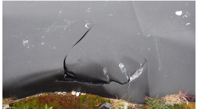
Photo 34 : Bassins des eaux usées, no.2 : Géomembrane endommagée sur la crête de la digue.
