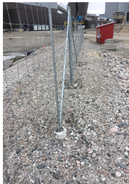
Figure 3 - Érosion sur la crête côté Sud
