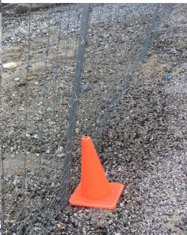
Figure 6 - Érosion pente amont côté Est
