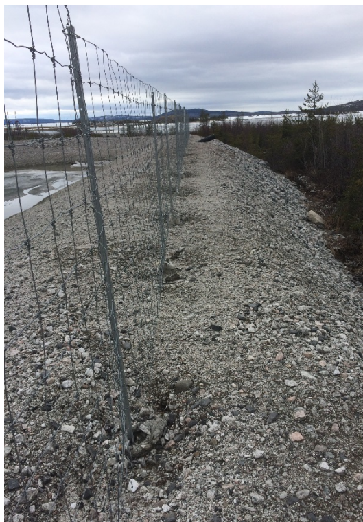
Figure 2 - Érosion sur la crête côté Nord-Ouest
