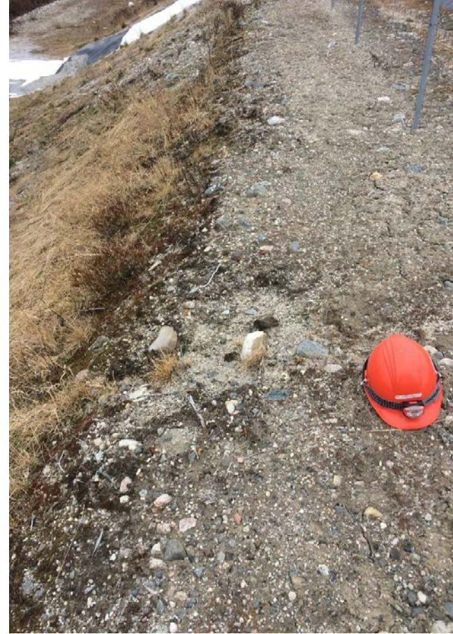
Figure 2 - Érosion sur la crête de la digue côté Sud
