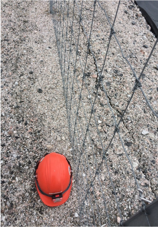
Figure 1 - Fissure longitudinale sur la crête de la digue côté Ouest
