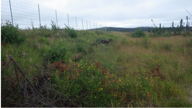
Photo 25 : Halde à stériles, BR1 : Érosion de la pente aval de la digue ouest.
