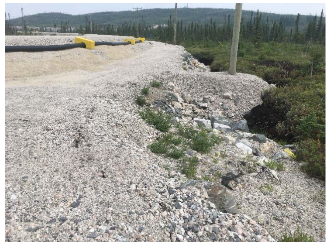
Photo 4 : Crête de la digue d'amorce et berme aval avec la conduite (sta 4+100). Présence de fissures longitudinales.
