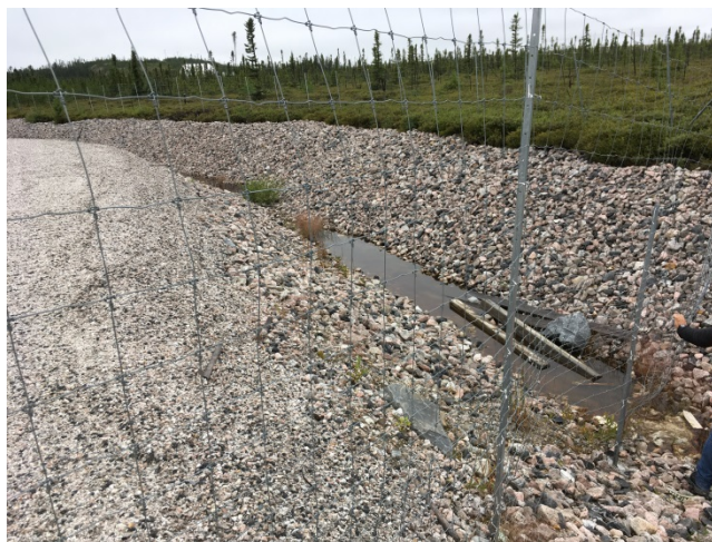
Photo 16 : UTEI, Bassin des eaux traitées : Débris dans le fossé nord.
