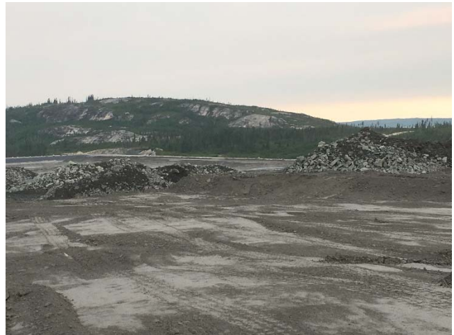
Photo 12 : Phase 1 du PAR. Déposition des résidus compactés sur la pente d'avance. Construction des chemins d'accès avec de l'enrochement. Vue vers l'ouest.
