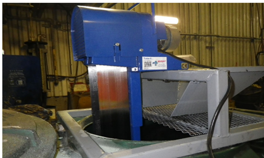
Figure 10-1 Photographie du séparateur d'huile du réservoir de transition
