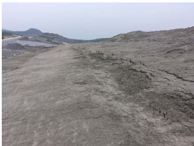
Photo 7 : Phase 1 du PAR. Pente aval des résidus avec des fissures longitudinales. Vue vers l'ouest.
