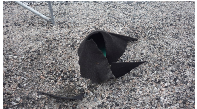
Photo 52 : Bassin des eaux de ruissellement, Zone 4 : Présence d'érosion autour d'un tuyau existant.
