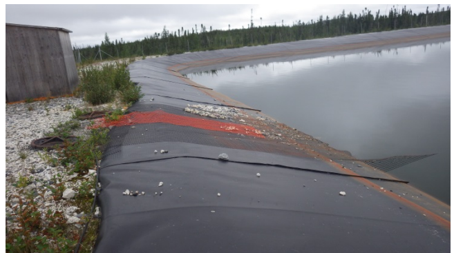
Photo 36 : Bassins des eaux usées, no.2 : Vue de la digue est avec du gravier sur la géomembrane.
