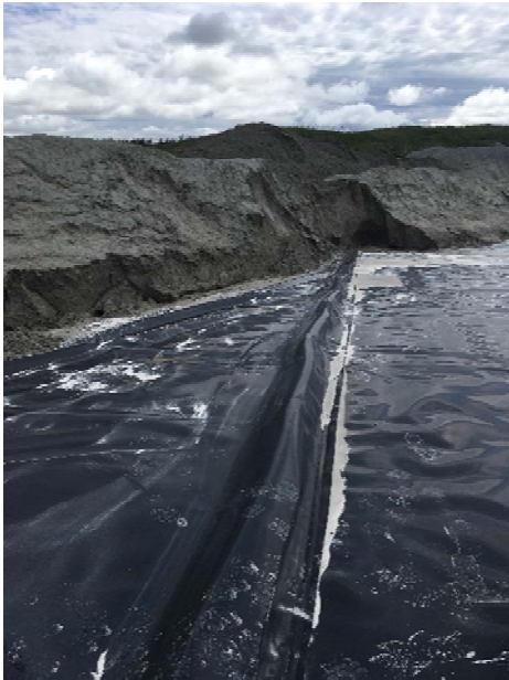
Photo 17 : Phase 2 du PAR. Des plis dans la géomembrane.
