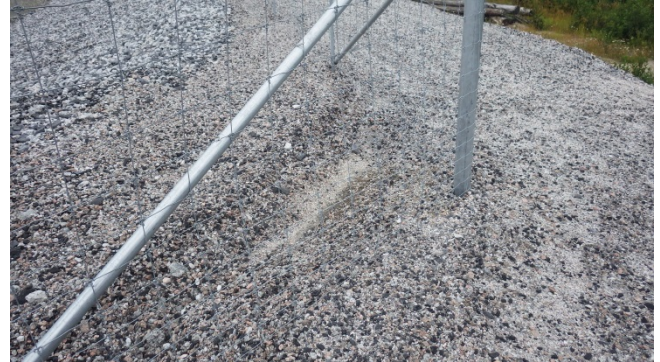
Photo 54 : Bassin des eaux de ruissellement, Zone 4 : Présence d'érosion sur la pente de la digue est.
