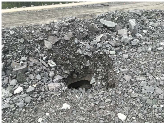
Photo 13 : Phase 1 du PAR. Ponceau endommagé sur la banquette.
