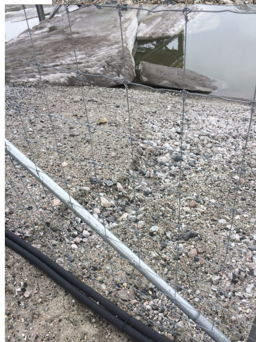
Figure 7 - Érosion pente amont côté Est
