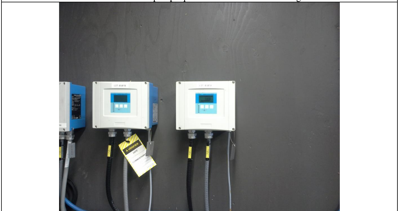
Photo 2 : Vue sur l'afficheur local du débitmètre
