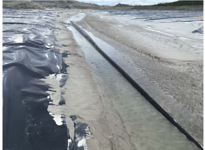
Photo 18 : Phase 2 du PAR. Fossé de transfert avec un pli dans la géomembrane (à réparer). Vue vers l'est.
