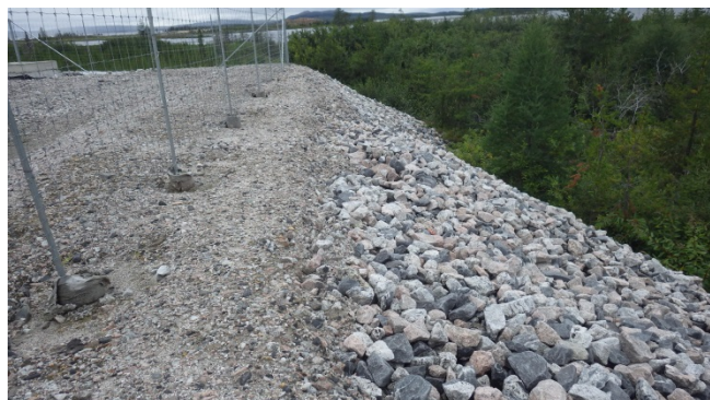
Photo 47 : Bassin des eaux de ruissellement, Zone 3 : Présence d'une fissure longitudinale sur le côté aval de la digue nord.
