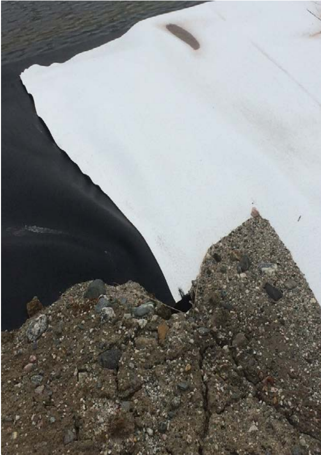
Figure 1 - Ouverture dans la géomembrane au niveau du déversoir sur la crête de la digue côté Sud
