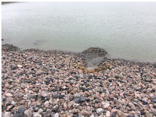
Photo 9 : UTEI, Bassin de polissage : Érosion du talus amont de la digue à côté du bassin de décantation.
