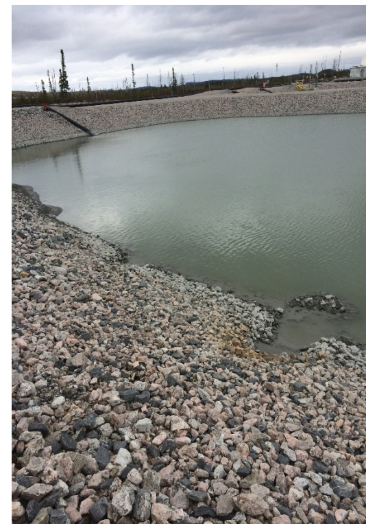
Figure 1 - Érosion dans la pente amont côté Sud-Ouest
