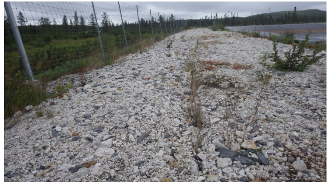
Photo 32 : Bassins des eaux usées, no.1 : La digue sud avec des fissures sur la pente aval.
