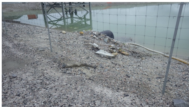
Photo 48 : Bassin des eaux de ruissellement, Zone 3 : Présence d'érosion sur la pente amont de la digue ouest.
