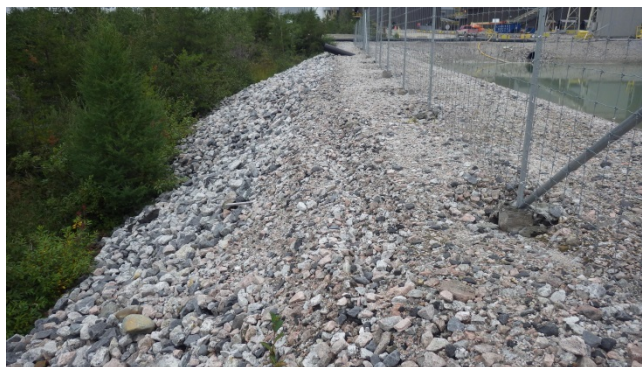
Photo 46 : Bassin des eaux de ruissellement, Zone 3 : Présence d'une fissure longitudinale sur le côté aval de la digue nord.
