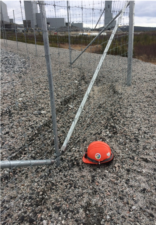
Figure 1 - Érosion sur la digue coin Sud-Ouest
