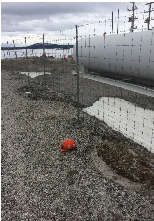
Figure 2 - Érosion sur la crête de la digue côté Sud-Ouest
