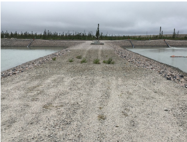
Photo 3 : UTEI, Déversoir entre les Bassin de sédimentation et polissage : Vue au nord.
