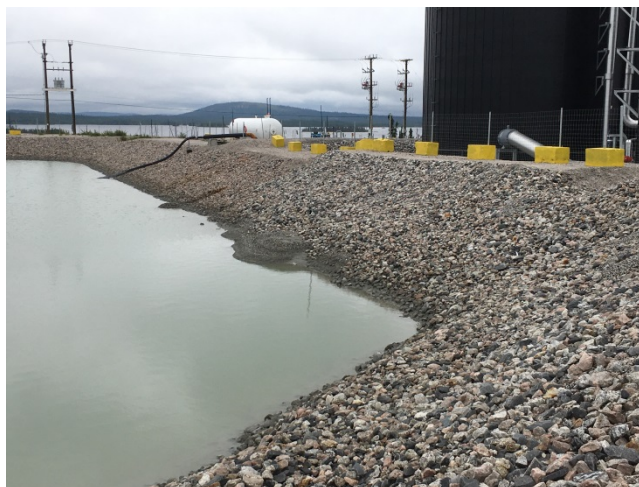
Photo 10 : UTEI, Bassin de polissage : Érosion du talus amont de la digue.
