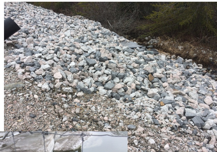
Figure 5 - Érosion pente aval côté Nord-Ouest
