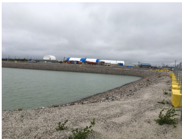
Photo 12 : UTEI, Bassin de polissage : Vue vers l'est. La berme amont de la digue sud de la route d'accès.
