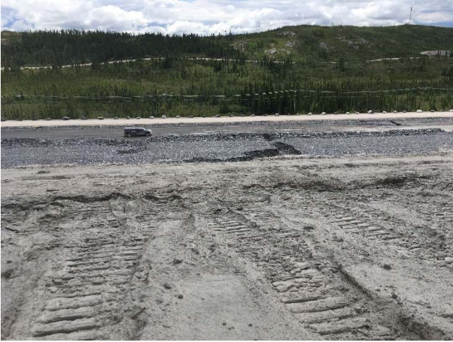
Photo 9 : Phase 1 du PAR. Pente aval avec le tassement des résidus, présence de fissures longitudinales et érosion. Vue vers le sud.
