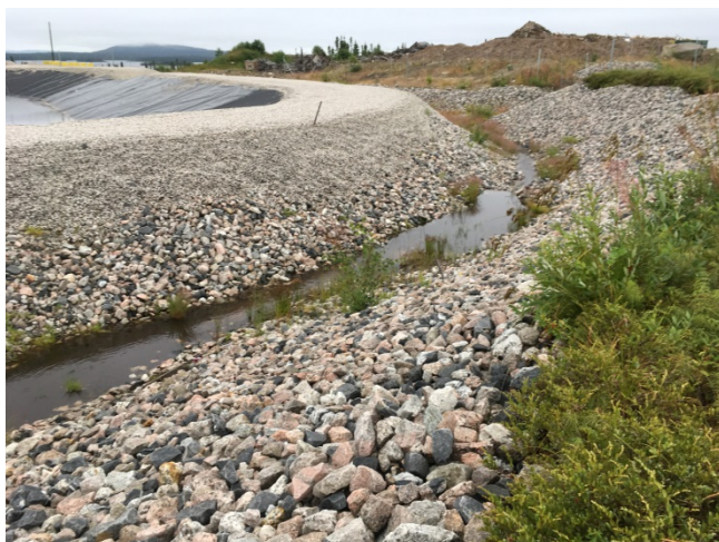
Photo 15 : UTEI, Bassin des eaux traitées : Le fossé au nord du bassin. De la tourbe est présente au fond du fossé. Affaissement de la pente du terrain du fossé.
