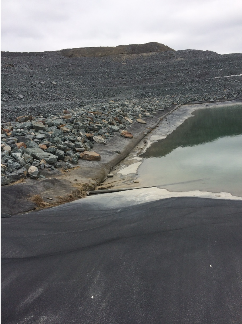
Figure 1 présence de pierre sur la géo membrane
