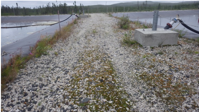
Photo 33 : Bassins des eaux usées, no.1 : La digue interne entre les deux bassins, vers l'est.
