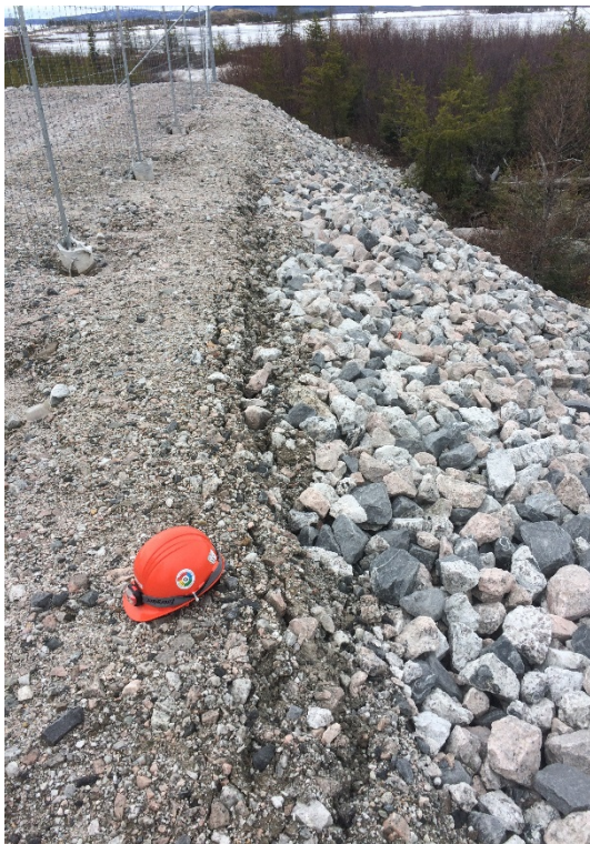
Figure 4 - Fissure longitudinale pente aval côté Nord-Ouest
