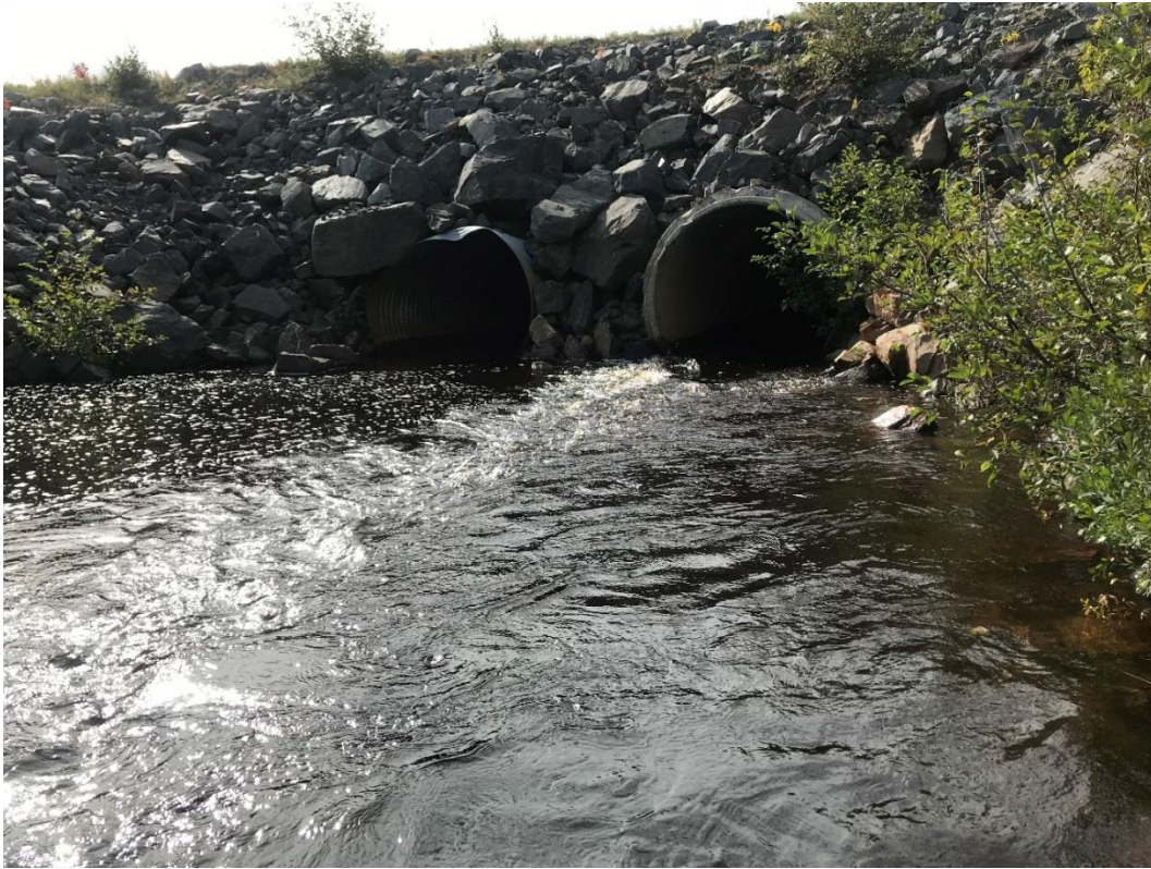
Photo 1 : Vue vers l'amont du segment 11 montrant les vitesses d'écoulement élevées à la sortie de ponceaux (DDM, 19 sept. 2019).
