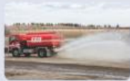
Utilisation d'eau et d'abat-poussière sur les voies non pavées et nettoyage de la cour au balai mécanique
