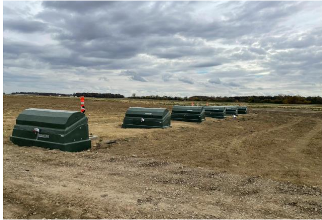
Figure 4-2 – Boîtes de jonction (source : EDF)
