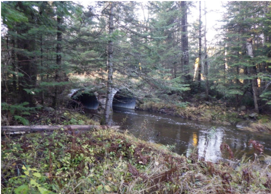
Photo 25 Zone 8, vue des ponceaux aménagés sous le chemin forestier afin de permettre l'écoulement de la rivière Nebnellis (photo prise vers le nord-est)
