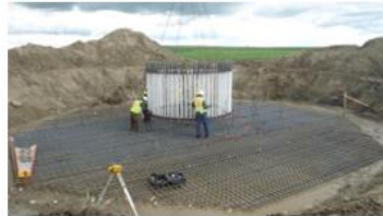
La pose de l'acier d'armature comprend entre 50 et 70 tonnes de barres d'armature.
