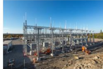
Poste électrique du projet
