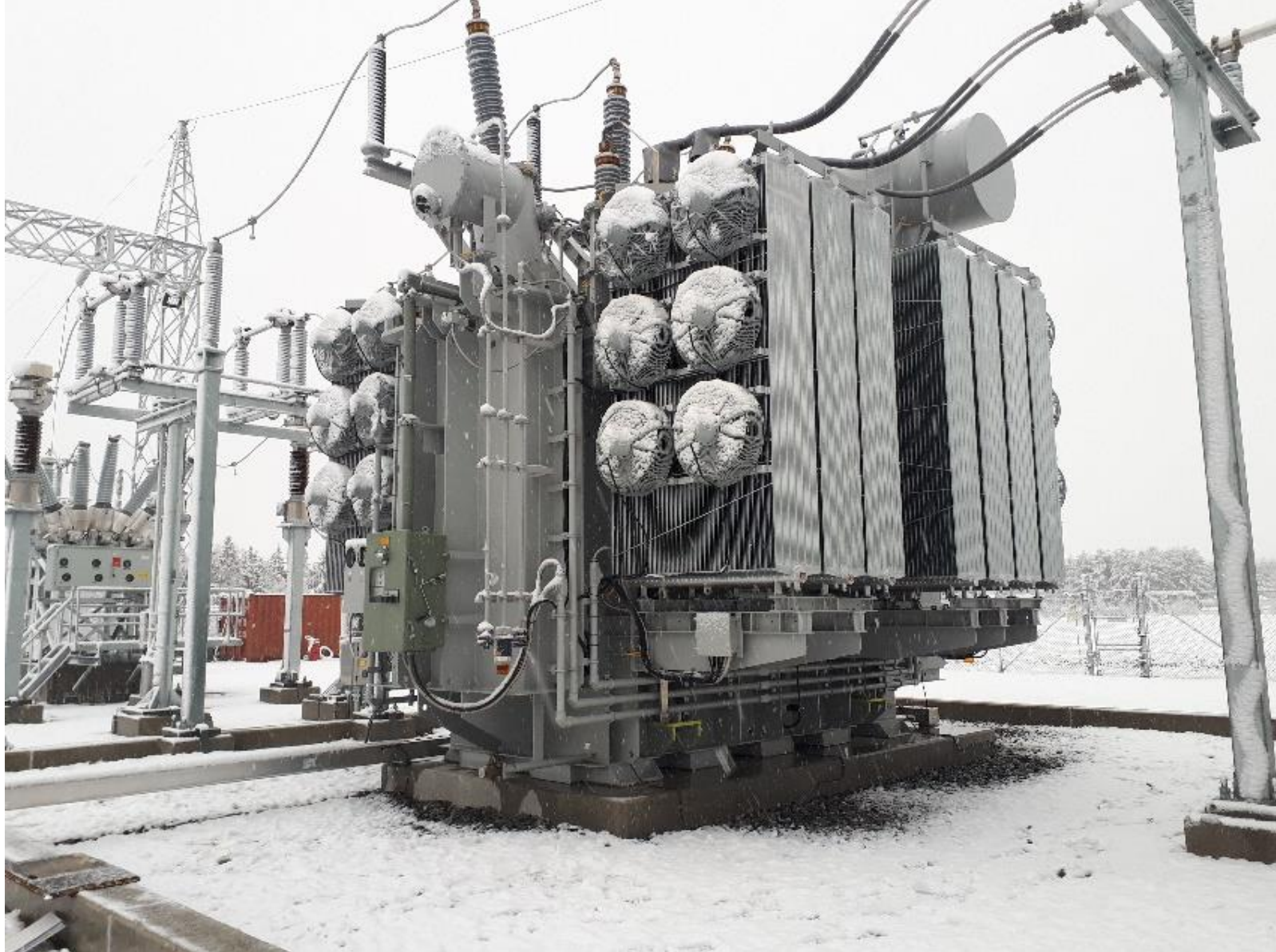
Transformateur à la sous-station
