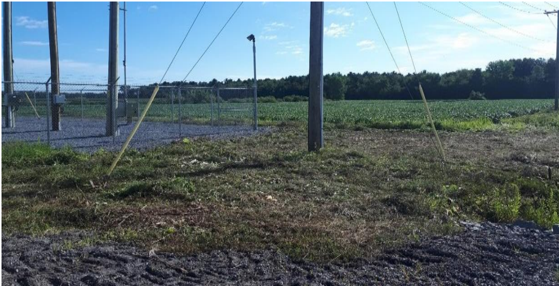
Poste de sectionnement.
