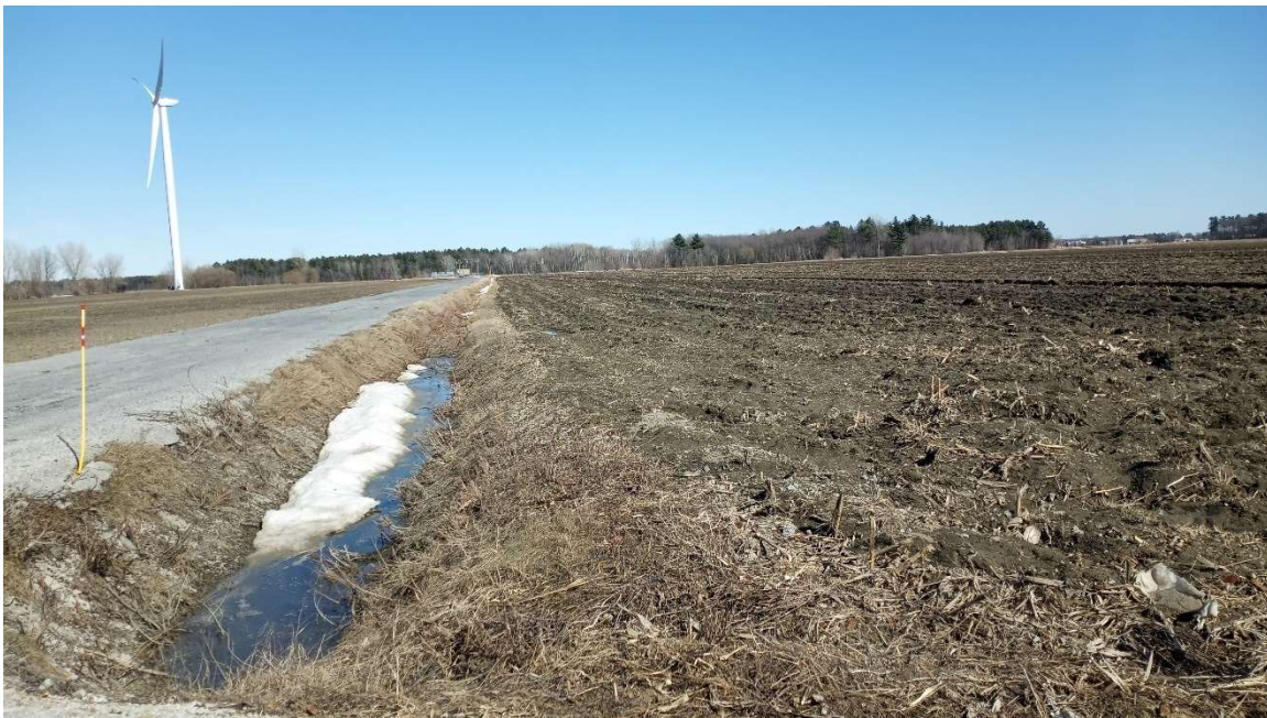
Photo 1 – creux lavant la fossé le long du chemin Brouillard (05 avril 2022)
