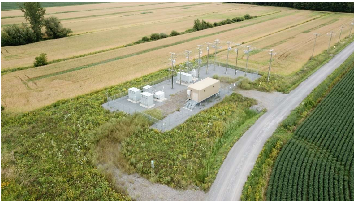
Photo de drone du poste de sectionnement (04 août 2022) – OPSIS, Solutions Écoénergétiques
