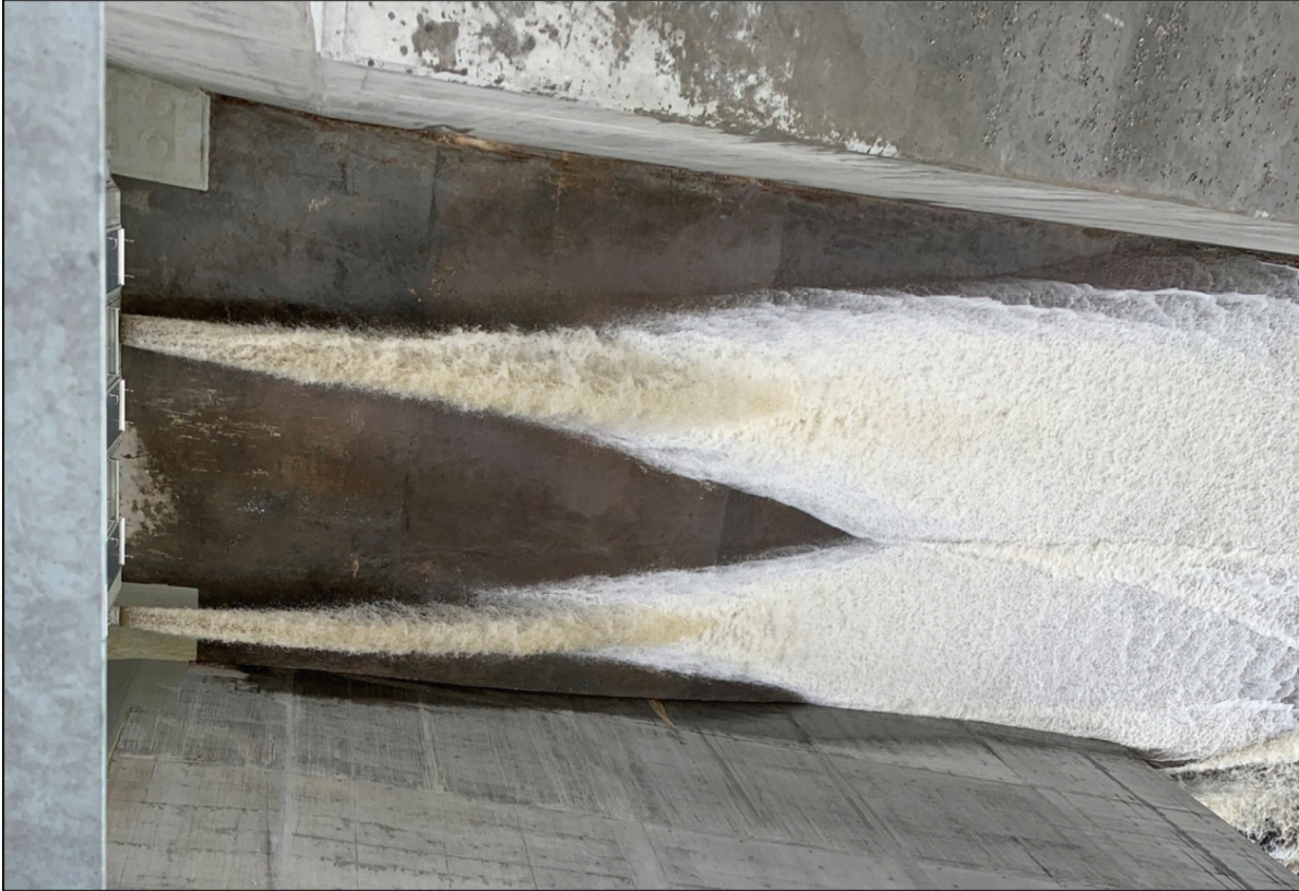
Photo 1 : Vannettes assurant le débit réservé dans une vanne de l'évacuateur de crue de la Romaine-4
