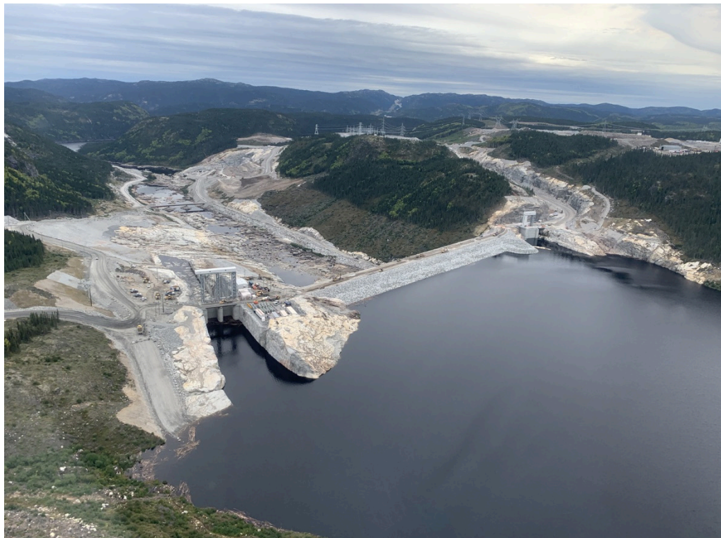
Réservoir de la Romaine 4 avec débit écologique à l'évacuateur de crues, le 9 sept. 2020
