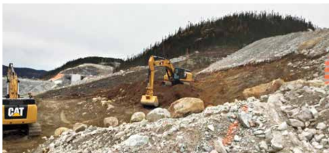
Décapage de l'emplacement de la rampe de mise à l'eau en rive du réservoir de la Romaine 4
