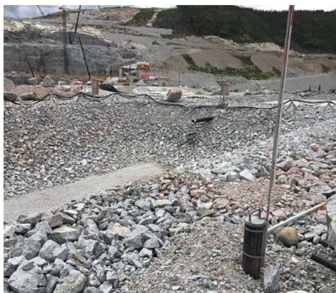
Bassin de sédimentation des particules fines présentes dans les eaux résiduelles provenant des travaux
