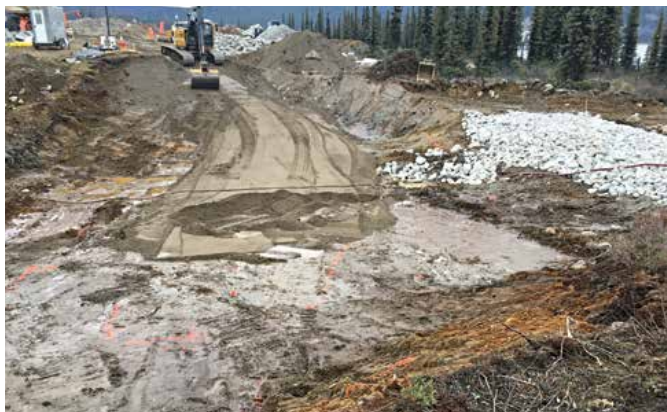
Aménagement d'un seuil infranchissable par les poissons dans le tributaire situé au PK 192 de la Romaine
