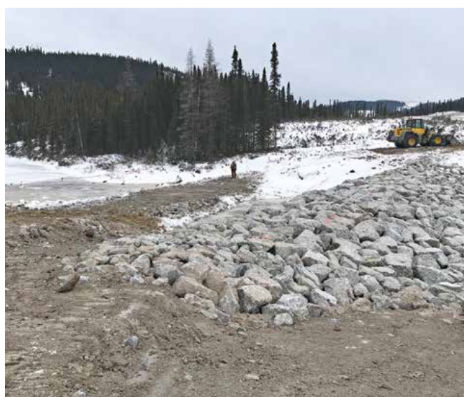
Seuil en enrochement et batardeau amont (en cours d'arasement) mis en place pour la protection de l'omble de fontaine présent dans le tributaire R1929248G
