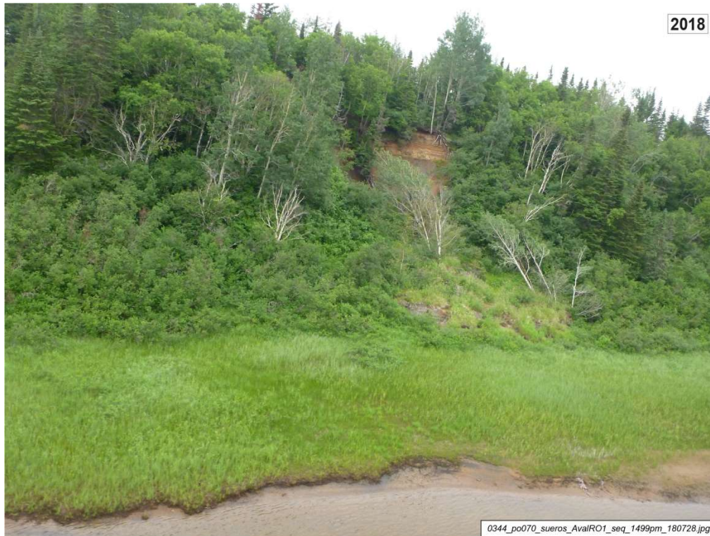
Photo 9. Entre les PK 22 et 25 sur la rive nord de la rivière, les hauts talus riverains sont largement stabilisés. Des éboulements ponctuels (comme celui montré ici, au PK 23,4) se sont cependant produits depuis 2015.
