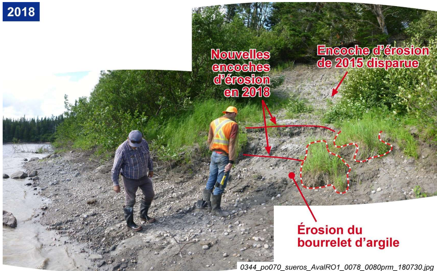
Photo A4-12 et A4-13 : Station témoin 2013-PG-03, rive droite PK 33,5. La comparaison de ces montages de photos de 2015 et de 2018 permet d'évaluer l'érosion qui s'est produite à la base du talus au cours des trois dernières années. L'érosion des argiles à la base du talus s'est poursuivie de sorte que le till sous-jacent affleure maintenant davantage sur la berge. Une partie du couvert d'herbacées en place en 2015 s'est éboulée sur la berge suite au recul du pied du talus.
