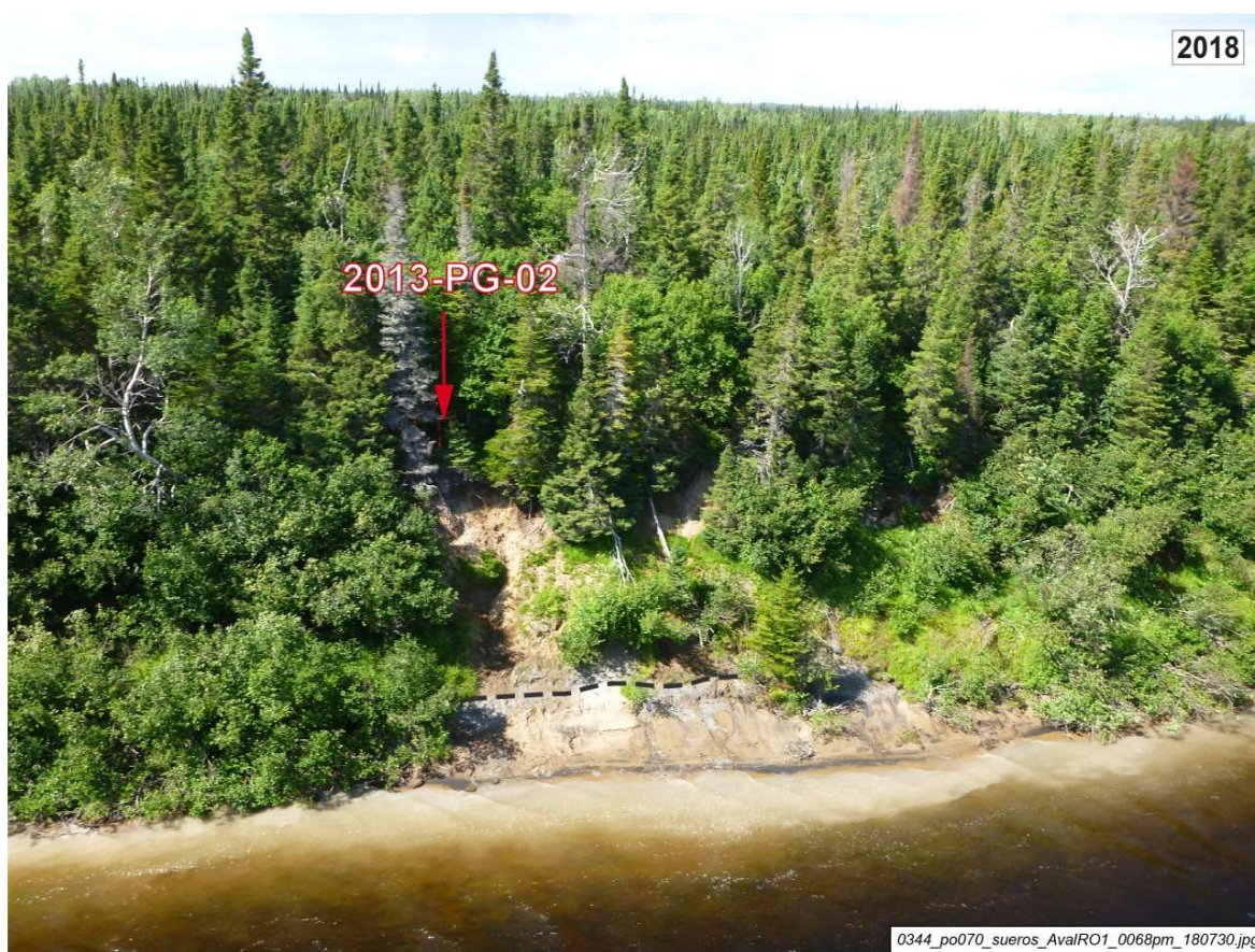
Photo A4-5 à A4-7 : Station témoin 2013-PG-02, île Mistaministukueetshuan PK 24,5. La station 2013-PG-02 est installée en bordure d'un talus argileux de 5 à 6 m de hauteur recouvert d'une couche de sable. Cette rive était déjà instable en 2013 et l'érosion se poursuit toujours en 2018, plus particulièrement à la base du talus (montré par un tireté noir sur la photo A4-7).
