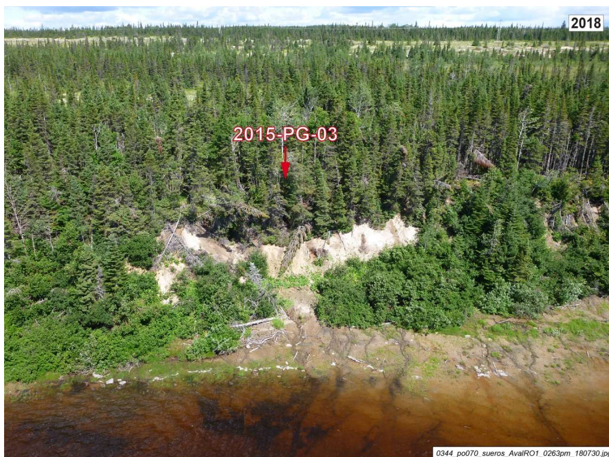
Photo A4-25 à A4-27 : Station témoin 2015-PG-03, rive droite PK 6. La station 2015-PG-03 recoupe un talus sableux instable d'environ 10 m de hauteur. Le profil général de la rive ne semble pas avoir changé de façon significative depuis 2015. Les relevés de 2018 révèlent la présence de micro-talus d'érosion à différents niveaux sur la berge qui indiquent que cette rive est toujours active.
