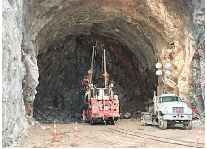
Excavation de l'entrée de la galerie d'amenée de la centrale de la Romaine-4
