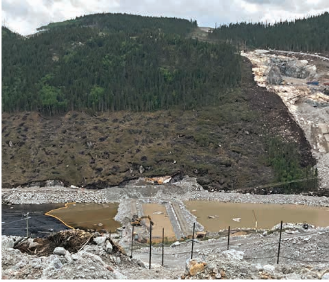
Construction du batardeau à l'aval du barrage de la Romaine-4 et rideau de confinement des sédiments
