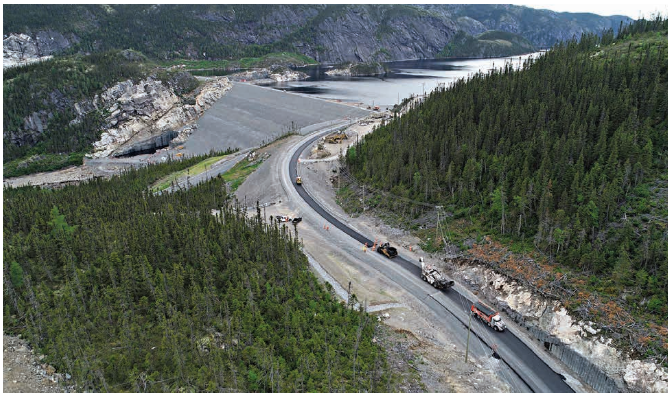
Asphaltage d'un segment de la route de la Romaine près du barrage de la Romaine-3
