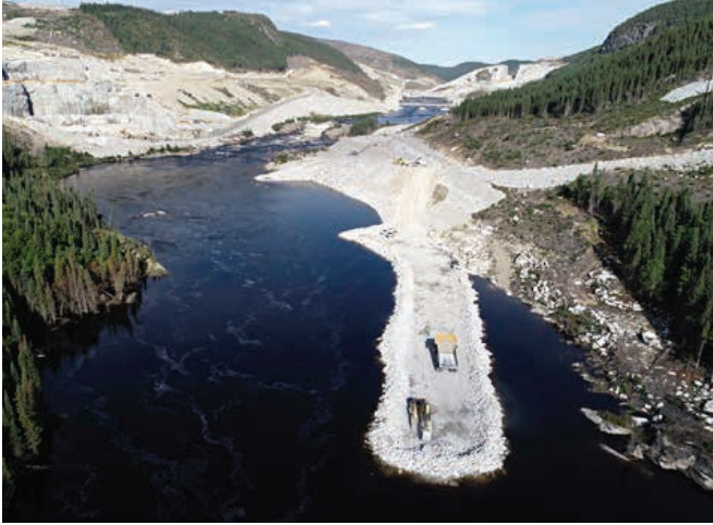
Jetée pour la construction du canal de fuite de la centrale de la Romaine-4
