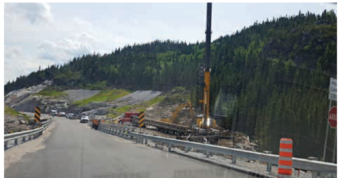
Démantèlement du pont provisoire accolé au nouveau pont permanent sur la rivière Glapion
