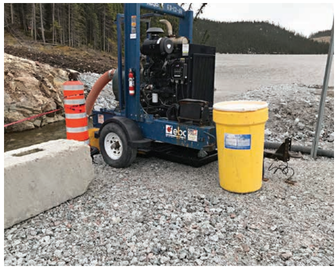
Bac contenant des matériaux d'absorption en cas de déversement accidentel de contaminants
