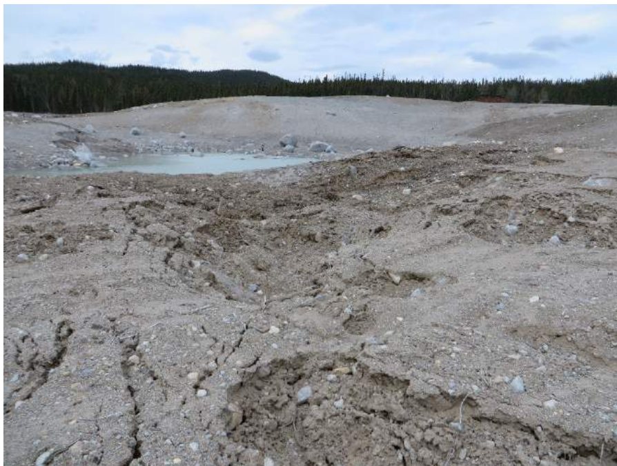
PHOTO 8 Zone d'affaissement du côté sud – 7 juin 2018
