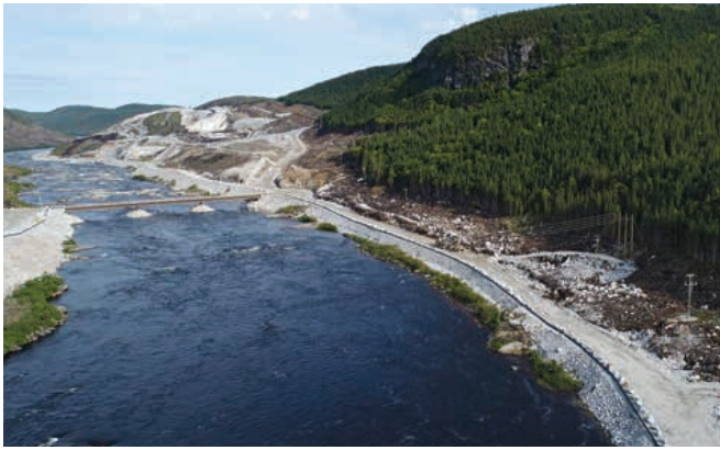
Pont provisoire sur la Romaine et chemin d'accès au barrage de la Romaine-4
