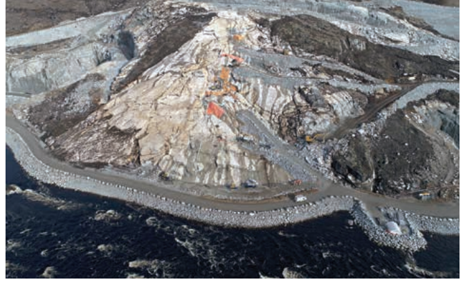
Décapage du mort-terrain jusqu'au roc à l'emplacement du barrage de la Romaine-4
