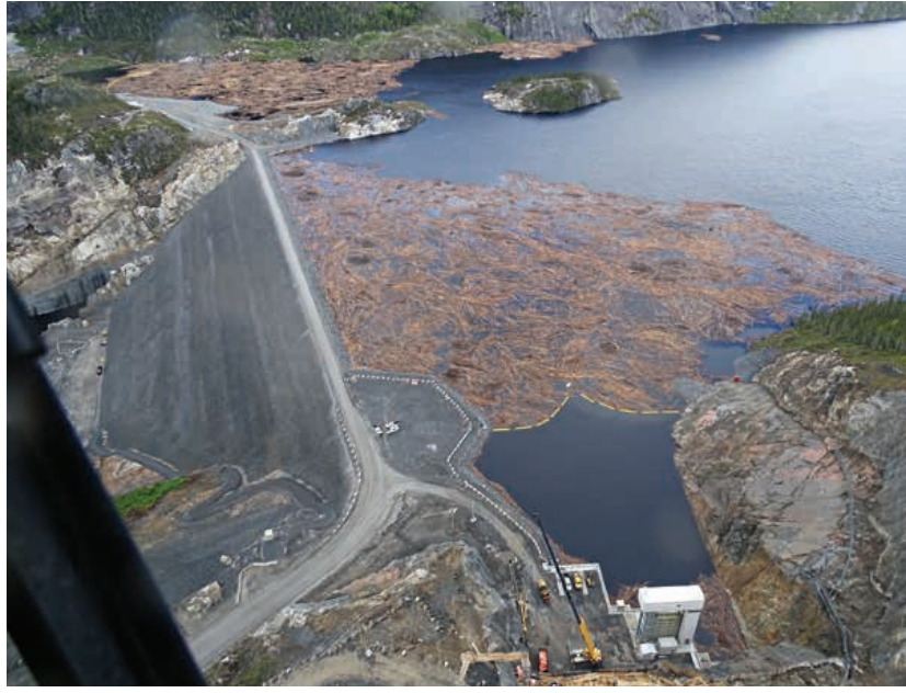
Accumulation de débris ligneux au barrage de la Romaine-3
