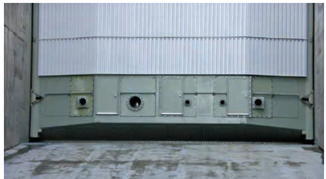
Vannettes assurant le débit réservé écologique à l'évacuateur de crues de la Romaine-3
