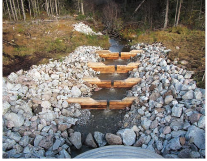
Seuils en bois mis en place en amont du ponceau du kilomètre 147+012
